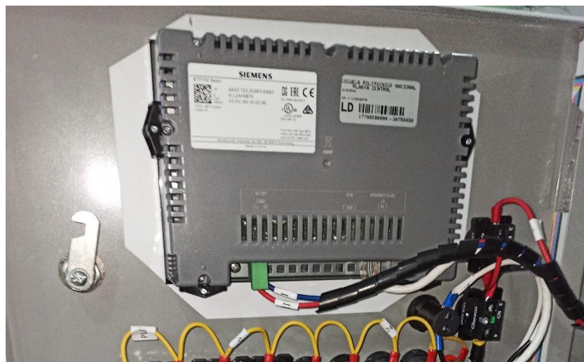
Figura 3.38 Cableado eléctrico de la pantalla HMI.
