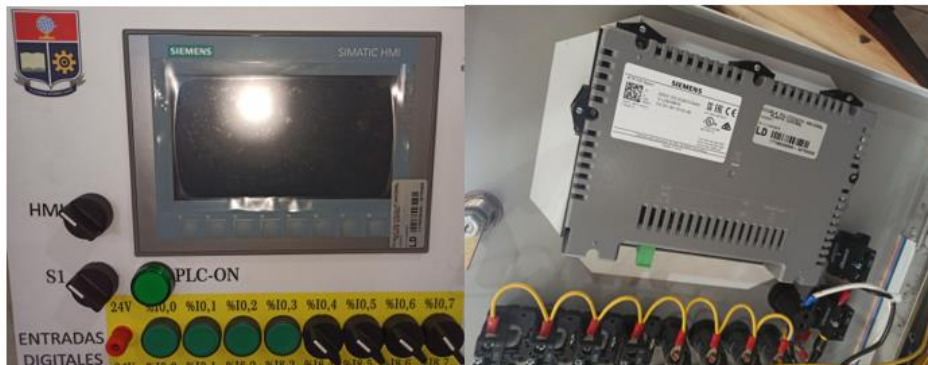
Figura 3.35 Ubicación de la pantalla HMI en las cubiertas de los módulos.
