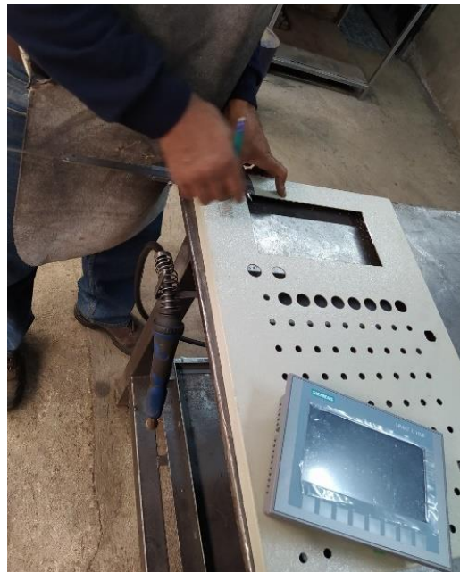
Figura 3.6 Medición del espacio designado para la pantalla HMI.
