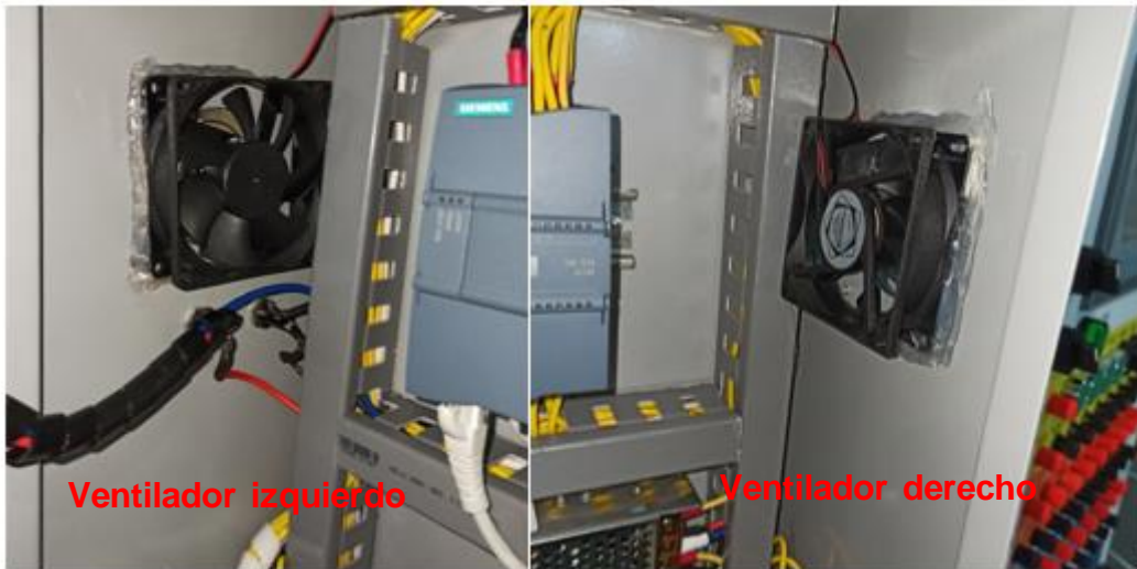
Figura 3.39 Ubicación de los ventiladores.
