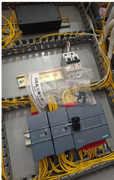
Figura 3.30 Cableado principal de los módulos didácticos.
