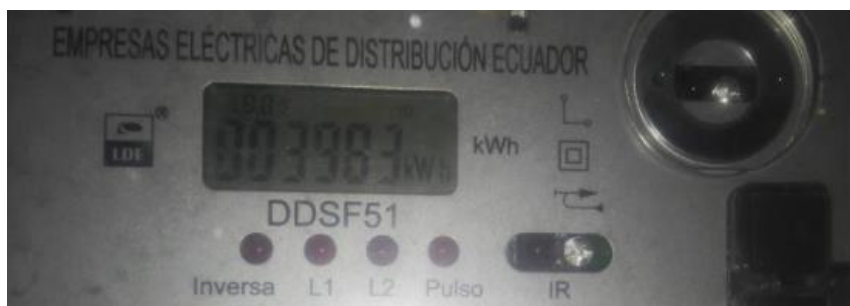
Figura 3.3 Lectura manual del medidor de energía
