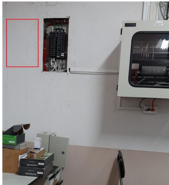
Figura 3.3 Ubicación del tablero de protección eléctrica
