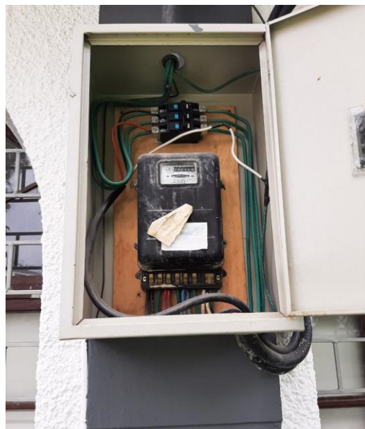
Figura 3.27 Medidor de energía eléctrica aulas ESFOT.
