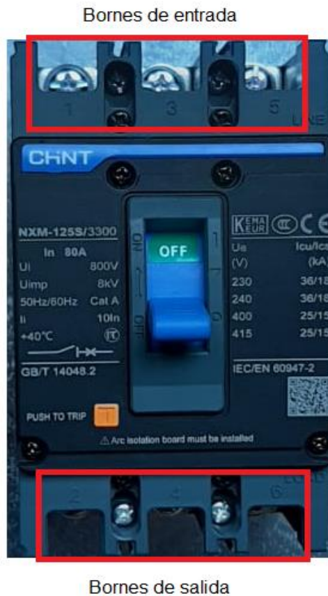
Figura 3.33 Bornes de entrada y salida del termomagnético.
