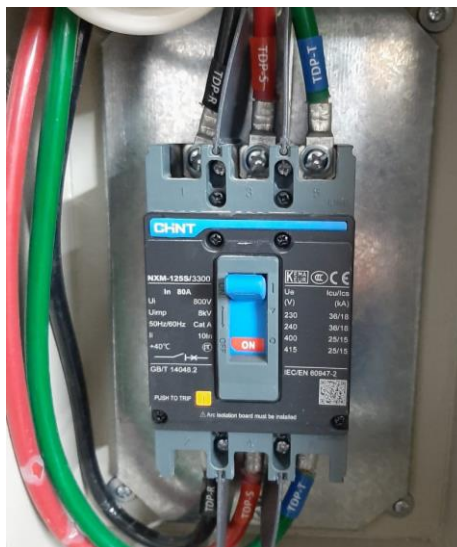
Figura 3.29 Conexión de cables en el termomagnético TP-LTI.
