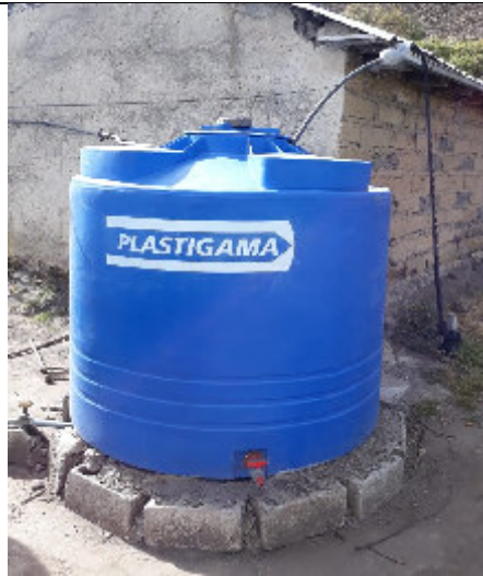
FOTOGRAFÍA 7: Tanque de almacenamiento de agua
