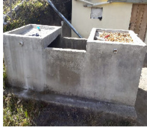
FOTOGRAFÍA 6: PIEDRA DE LAVAR SIN TUBERIA DE AGUA
