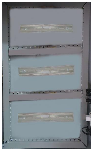
Figura 3.15 Disposición de canaletas dentro del gabinete.
