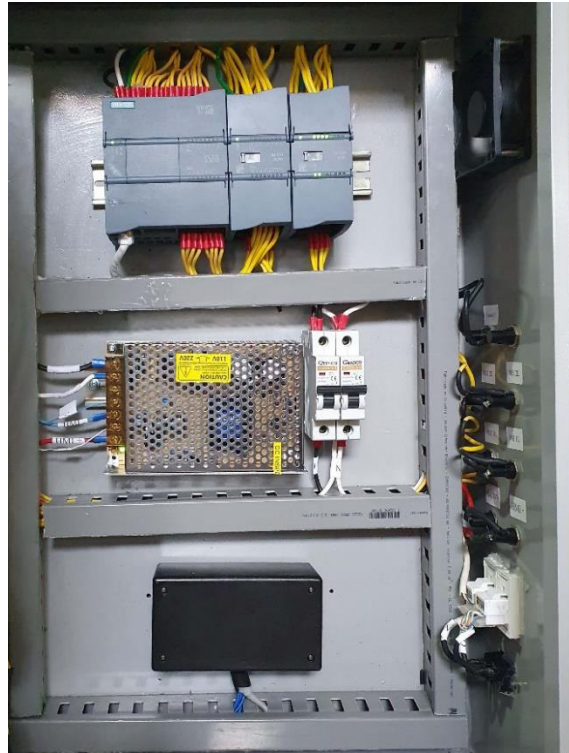
Figura 3.32 Conexiones organizadas dentro de canaletas.
