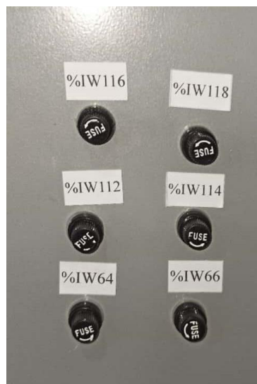
Figura 3.24 Portafusibles en la parte lateral izquierda del tablero.
