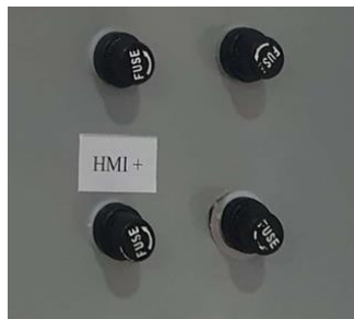
Figura 3.18 Portafusibles instalados en los módulos didácticos.
