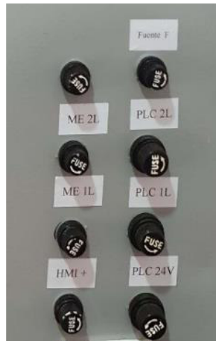
Figura 3.25 Portafusibles en la parte lateral derecha del tablero.
