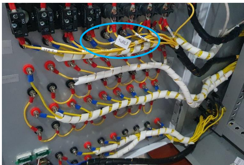
Figura 3.36 Etiquetado de conexiones.
