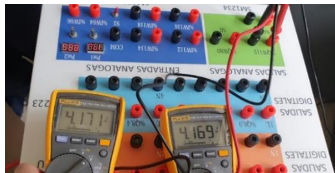
Figura 3.47 Verificación de voltaje en salidas analógicas del módulo SM 1234.
