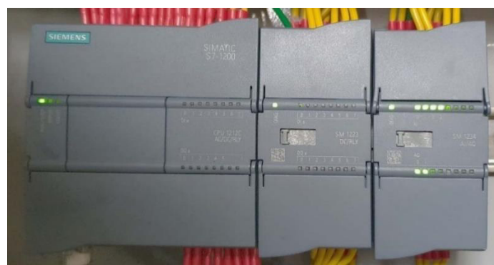
Figura 3.22 Conexión entre PLC S7-1200 y módulos de expansión.
