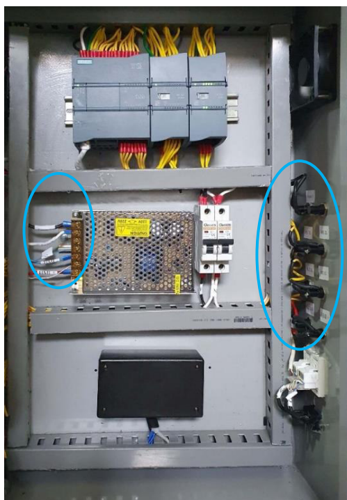
Figura 3.37 Etiquetas de las conexiones del interior del tablero.
