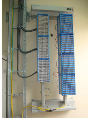
Fig. 2.4 Regletas para distribución de red de cobre
