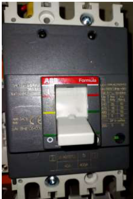
Figura 3.2 Interruptor automático principal de alimentación 40 (A).
