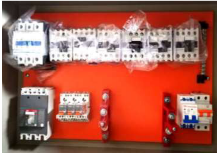
Figura 3.13 Prediseño al interior del gabinete.
