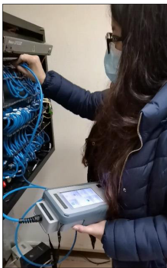
Figura A 81 Conexión de la unidad principal al patch panel ( link permanente)
