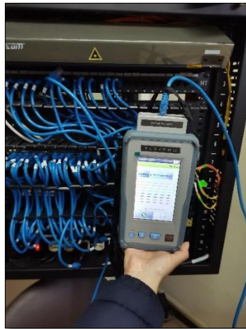
Figura A 53 Conexión de la unidad principal al patch panel
