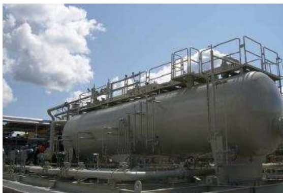
Figura 3.3. Separador instalado en CPF.
