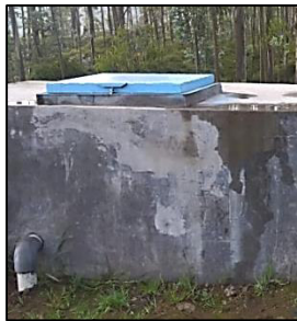
Figura 13. Tanque de Captación
