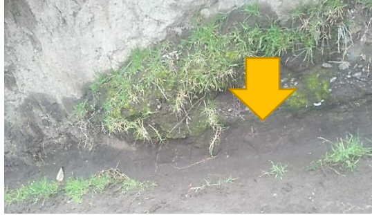
Figura 35. Tubería de distribución
