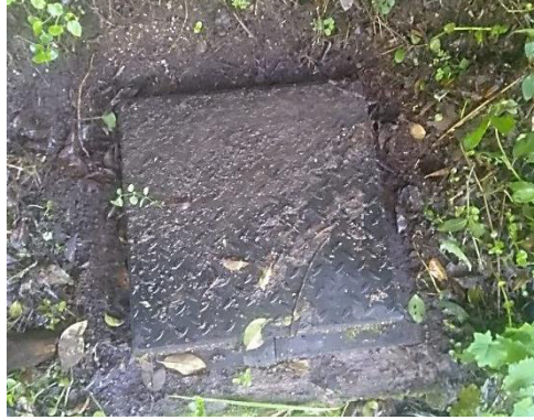
Figura 33. Válvulas de aire
