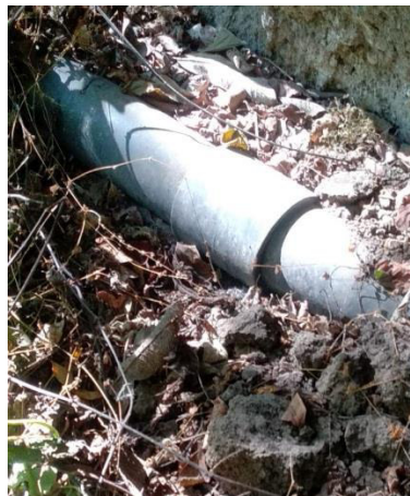
Figura 34. Tubería expuesta a lo largo de la línea de conducción
