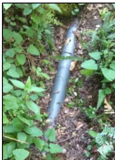
Figura 9. Tubería expuesta del sistema de conducción
