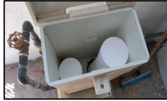
Figura 10. Desinfección en la Planta de Agua Potable
