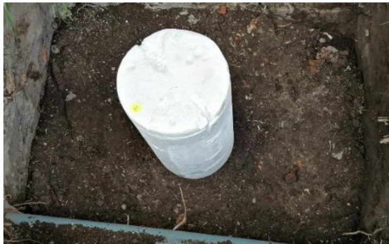
Figura 3.10 Registro del sistema de puesta a tierra. [5]
