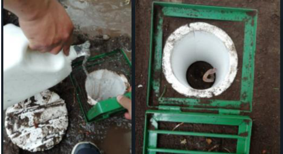
Figura 3.11 Sistema de puesta a tierra instalado [5].
