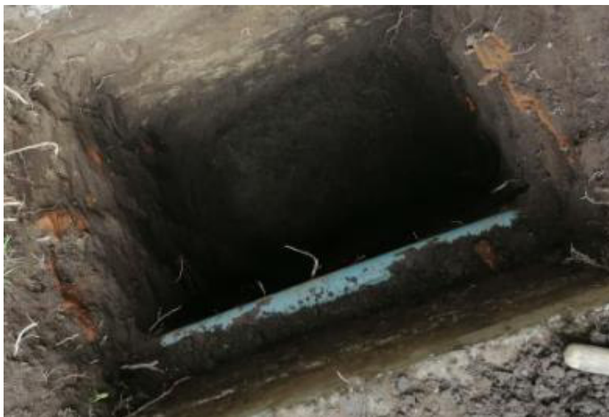
Figura 3.6 Pozo de puesta a tierra.
