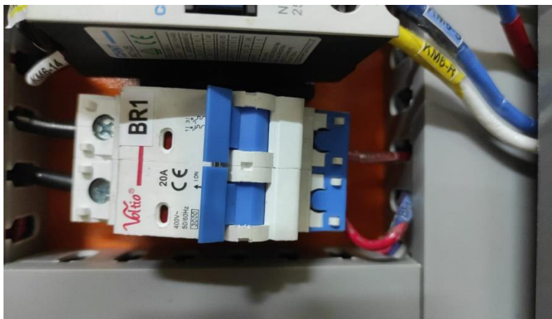
Figura 3.33 Acometida interruptor termomagnético
