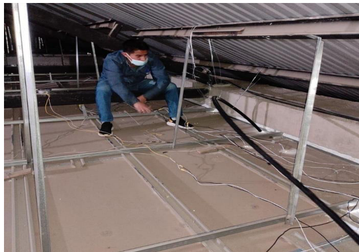
Figura 3.29 Distribución de cables por el techo
