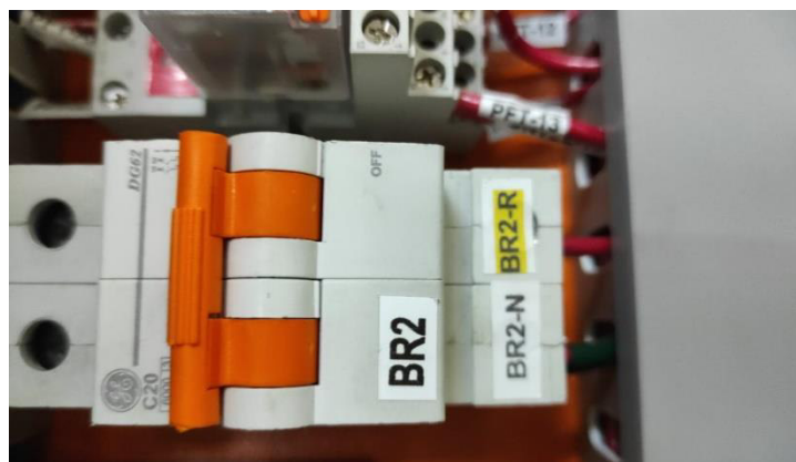
Figura 3.22 Termomagnético para ventilación
