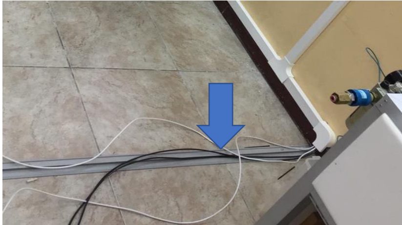
Figura 3.6 Canaleta de piso
