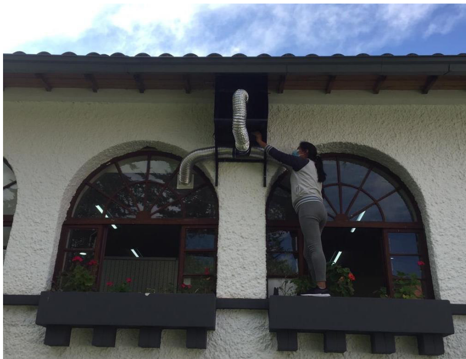
Figura 3.19 Ductos de aluminio de 5 pulgadas
