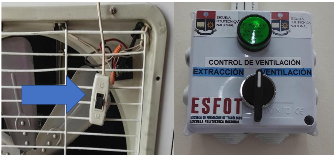
Figura 3.25 Módulo selector para control del sistema de extracción
