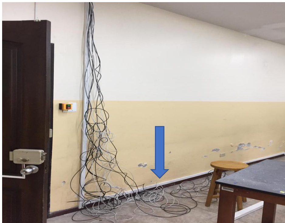
Figura 3.28 Canaletas de distribución mesas (1,2,3)
