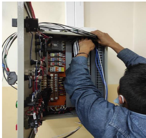
Figura 3.30 Acometida de cables en el tablero de distribución.
