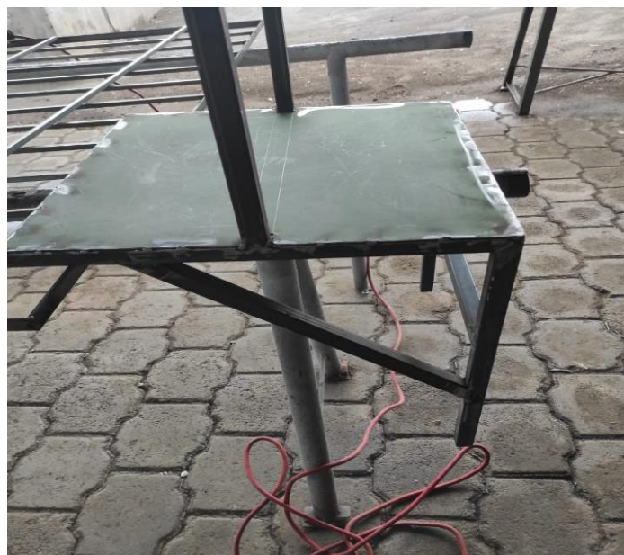
Figura 3.12 Soporte del sistema de extracción de aire
