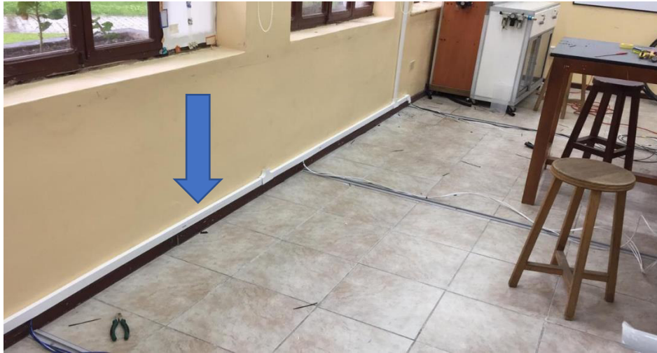
Figura 3.27 Canaletas de distribución mesas (4,5,6)
