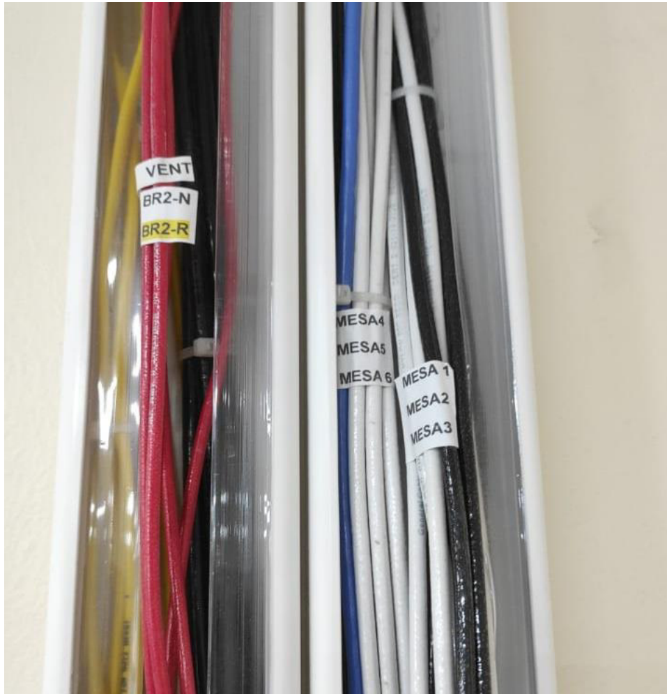
Figura 3.23 Etiquetado del cableado
