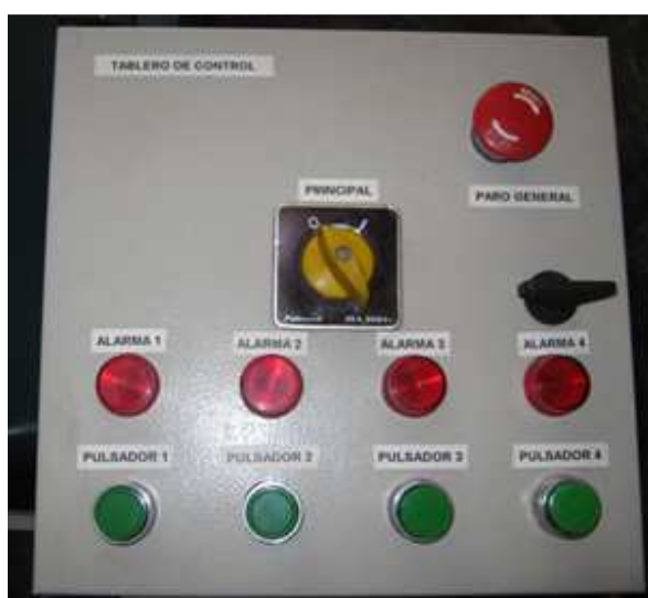
Fig. 20 “Tablero de control”
