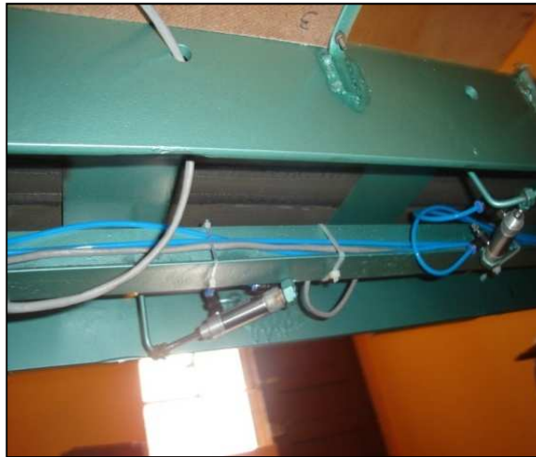
Fig. 40 “Tuberías para los cilindros neumáticos”
