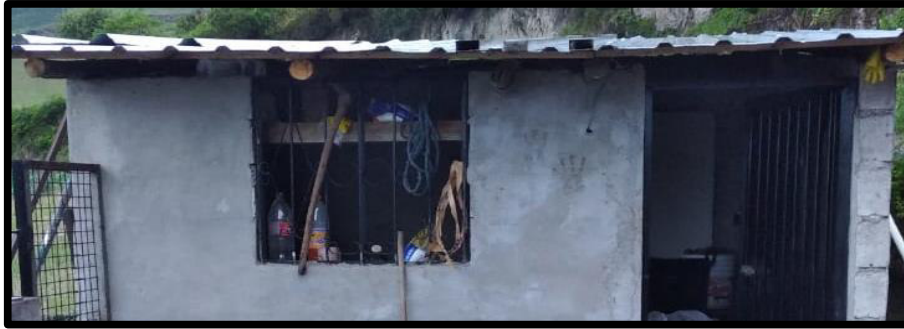
Figura 24. Techo zona B sin canaletas.
