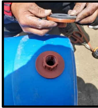
Figura 29. Implementación de acople en interceptor de primeras aguas.
