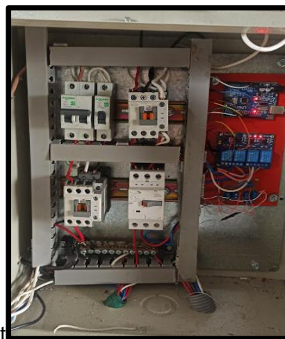
Figura 55. Tablero de control.
