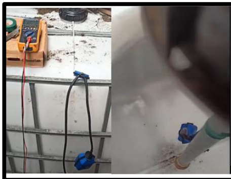
Figura 53. Conexión del electro nivel.
