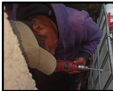
Figura 45. Perforación al tanque del almacenamiento
