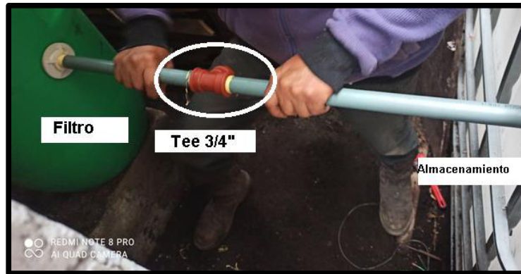
Figura 43. Tee entre el filtro y el tanque de almacenamiento.
