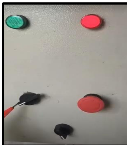
Figura 64. Activación del relé de agua.
