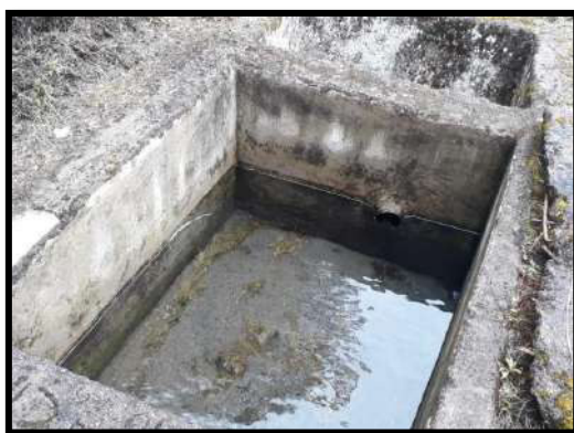
Figura 10. Tanque de captación
