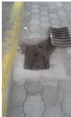
Figura 35. Sumidero obstruido con tierra.
