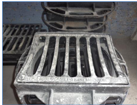
Figura 3. Rejilla de sumidero.
