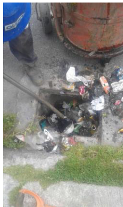
Figura 34. Sumidero obstruido con basura.
