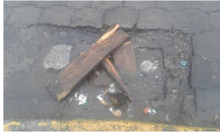
Figura 36. Sumidero obstruido maderas y escombros.
