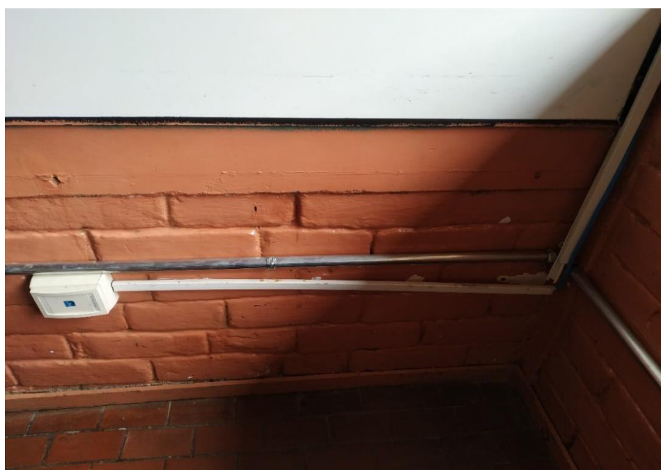
Figura 3.20 Punto de acceso ethernet mal ubicado.
