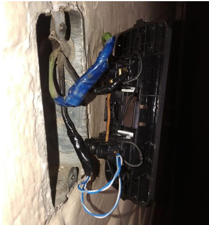
Figura 3.4 Interruptor con cinta eléctrica y conductores de diverso diámetro.
