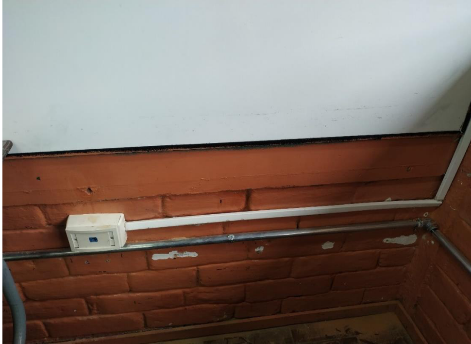
Figura 3.21 Reposicionamiento del punto de acceso ethernet en el aula 9.
