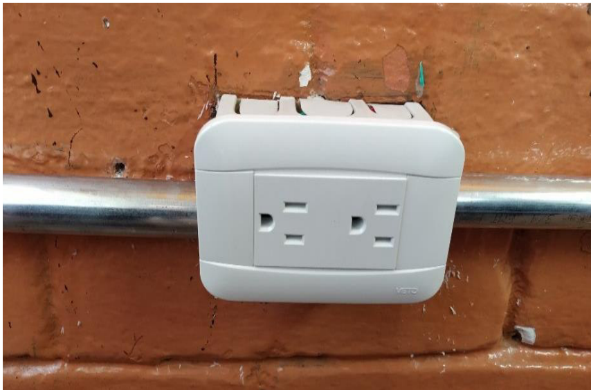
Figura 3.24 Acabado visual de cada tomacorriente.
