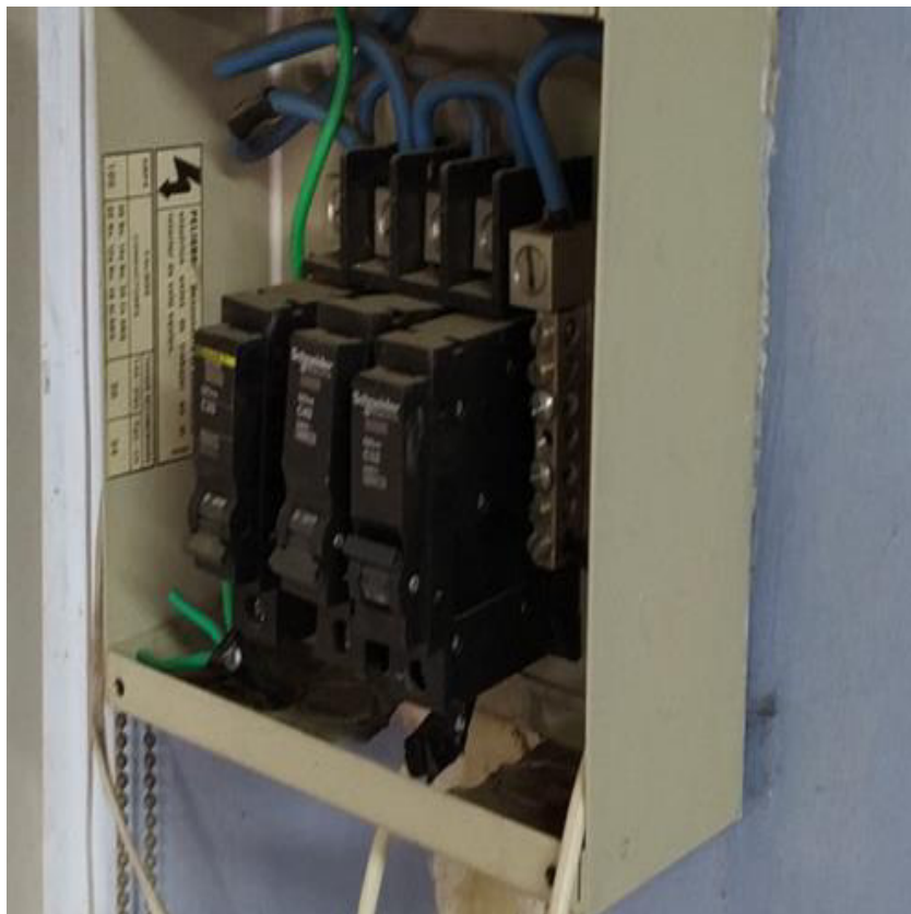
Figura 3.33 Caja térmica con puesta a tierra física del aula 7.
