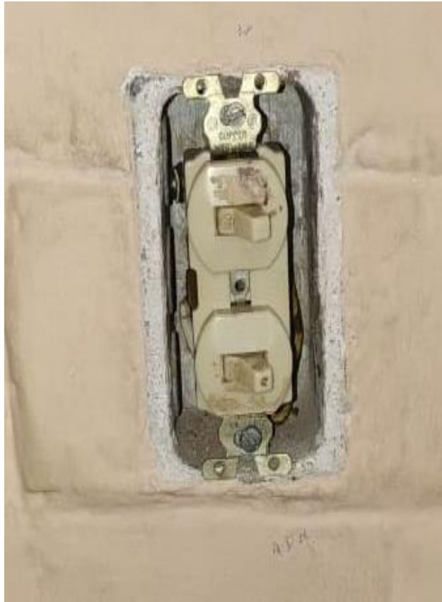
Figura 3.2 Estado interruptor aula 08.
