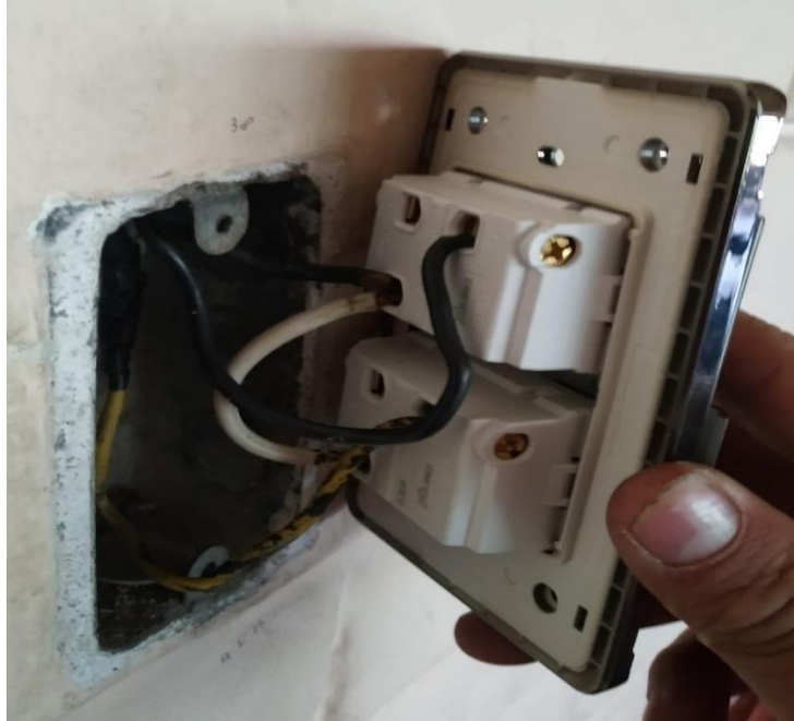
Figura 3.26 Instalación de interruptores respetando la simbología del fabricante. En el caso de la instalación de interruptores solo se realizó el cambio de los ya existentes a otros de mejor calidad y aspecto visual como se muestra en la Figura 3.27.
