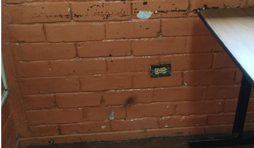
Figura 3.3 Estado tomacorriente aula 09.
