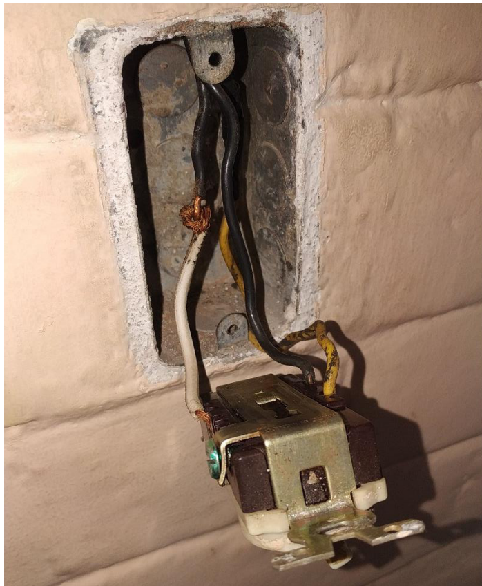
Figura 3.6 Conexiones inseguras y propensas a sufrir un cortocircuito.
