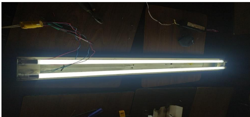
Figura 3.15 Comprobación del funcionamiento de los tubos led por luminaria.
