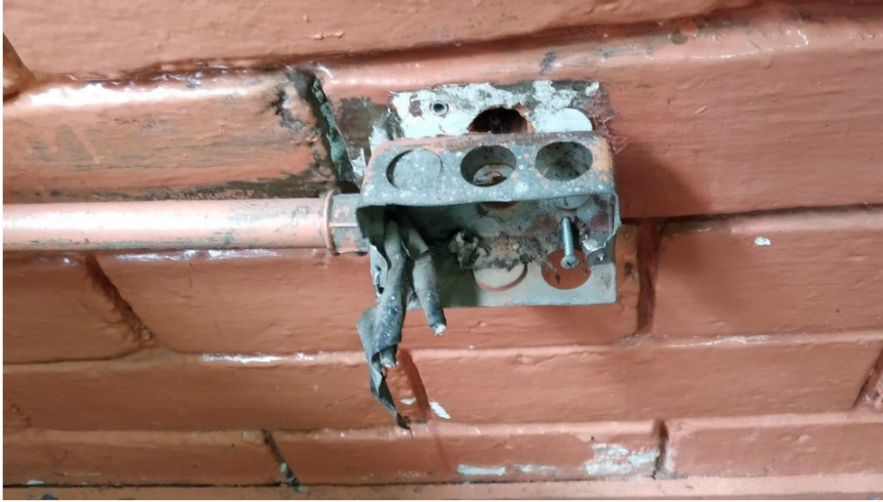
Figura 3.1 Estado del cajetín aula 07.
