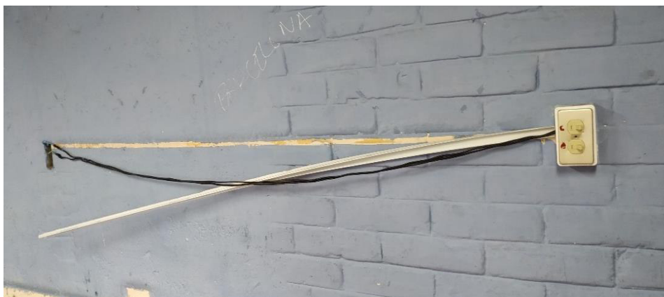
Figura 3.18 Interruptor en mal estado del aula 7.
