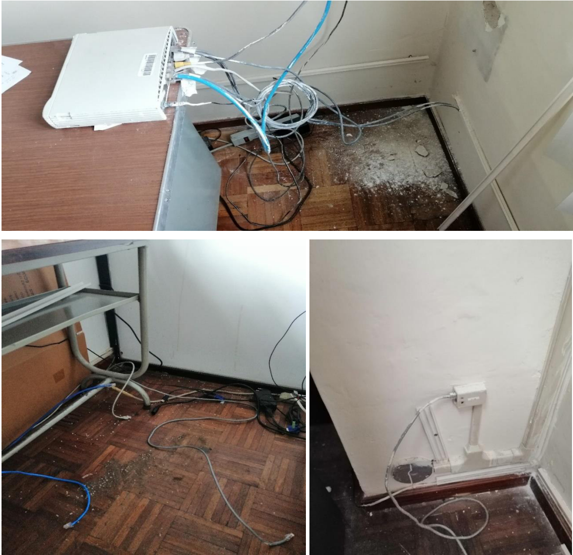
Figura 3.9 Cables de red tirados sin protección o en malas condiciones.
