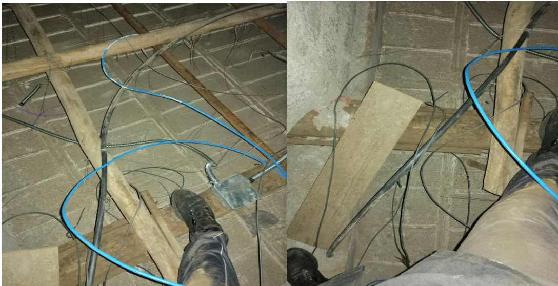
Figura 3.7 Estado del cableado horizontal en el techo
