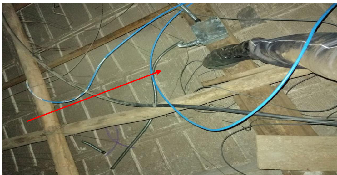
Figura 3.8 Cable de red hacia el área de Oficinas 4
