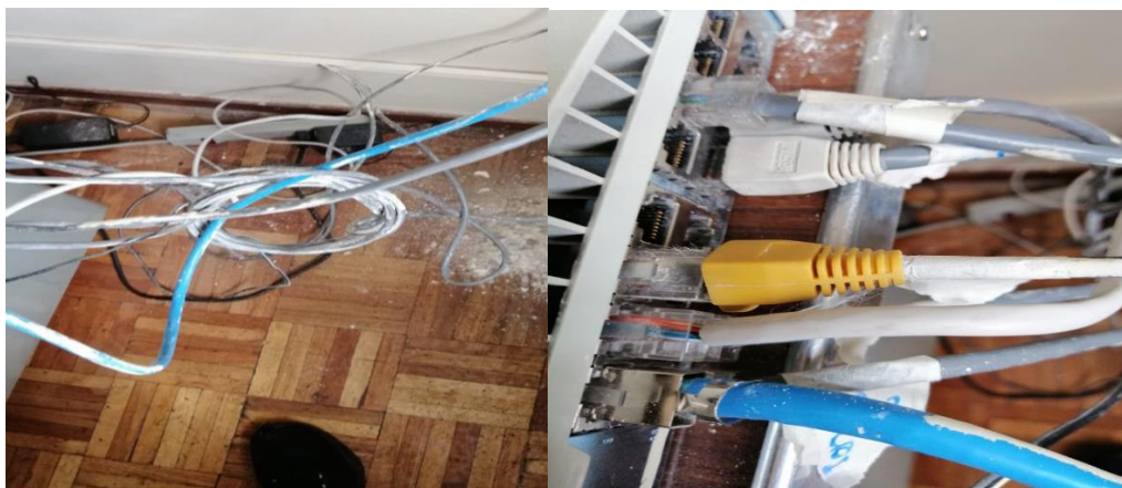
Figura 3.5 Estado de los cables de red y conectores RJ45
