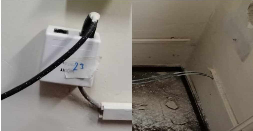
Figura 3.6 Estado de las canaletas
