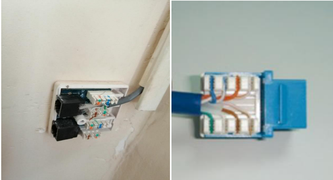
Figura 3.13 Ponchado del cable de red en el jack
