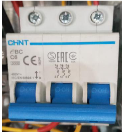
Figura 3.13 Interruptor termomagnético principal.
