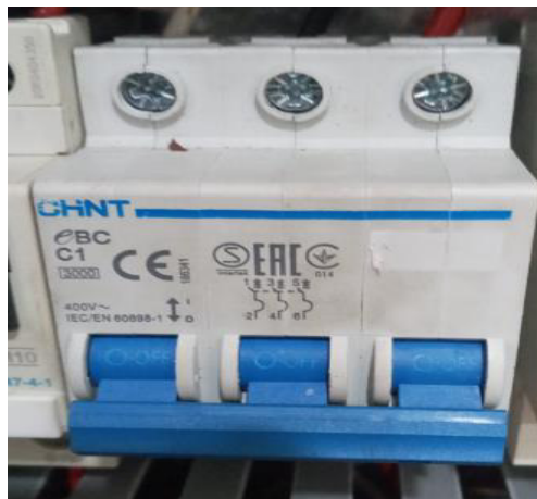
Figura 3.14 Interruptor termomagnético secundario.
