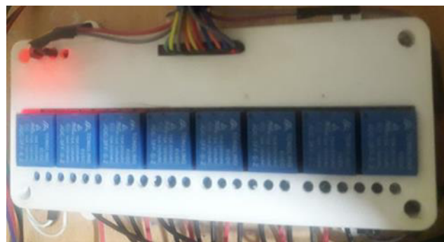
Figura 3.344 Relé que controla el ventilador encendido
