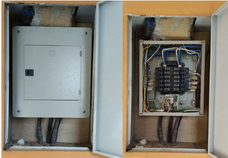
Figura 3.3 Caja de revisión Aulas 15-24.
