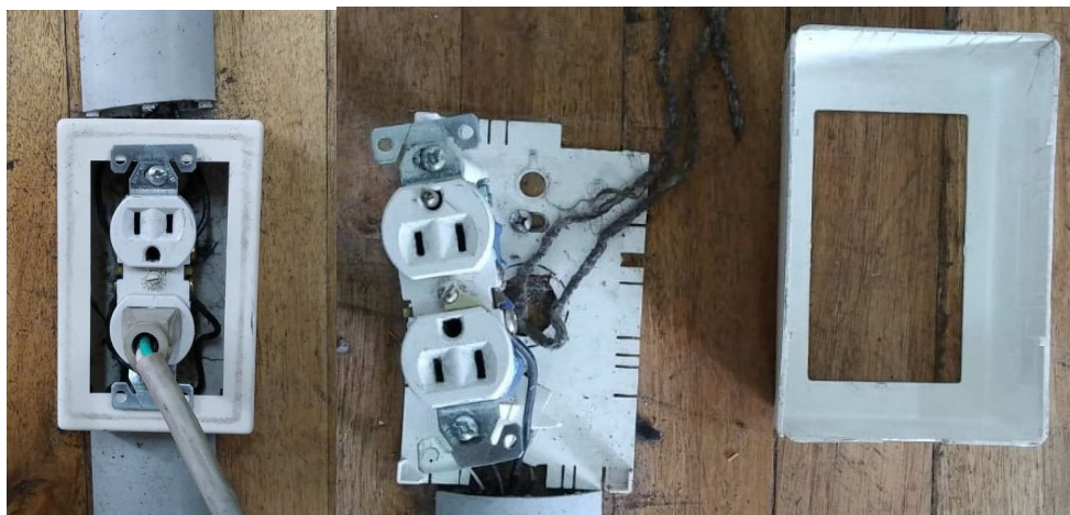
Figura 3.18 Condiciones de las canaletas en mal estado.
