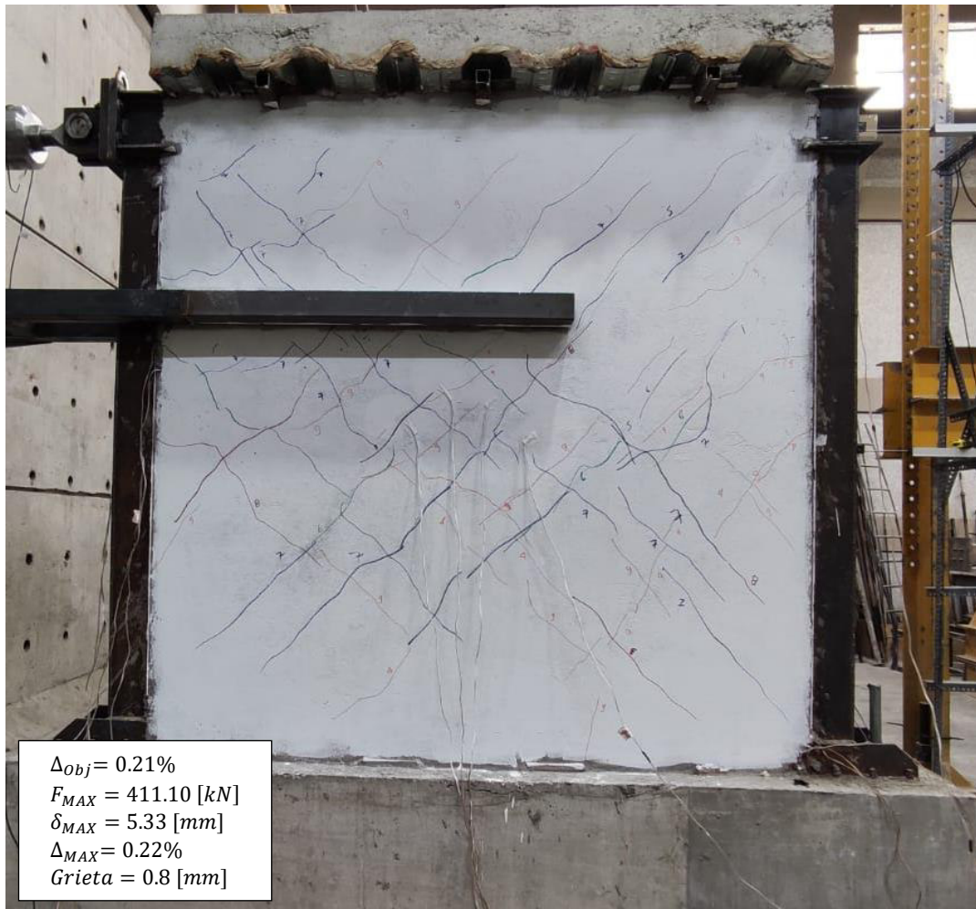
Figura 138. Imagen al final de “Daño Moderado”
