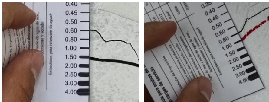
Figura 128. "Daño Moderado" Aparición y aumento de tamaño de grietas.
