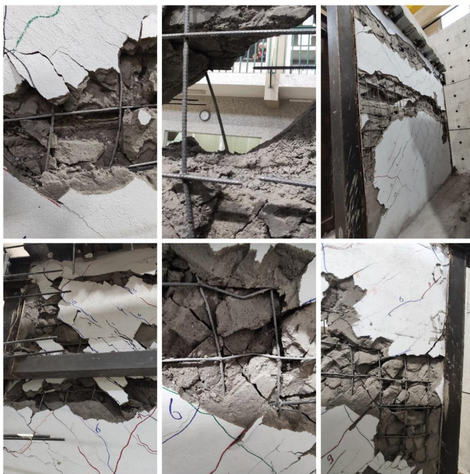
Figura 132. Daño completo en enchape sin daño previo
