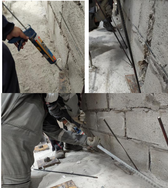
Figura 115. Colocación de Chicote en orificio con Adhesivo de alto desempeño.
