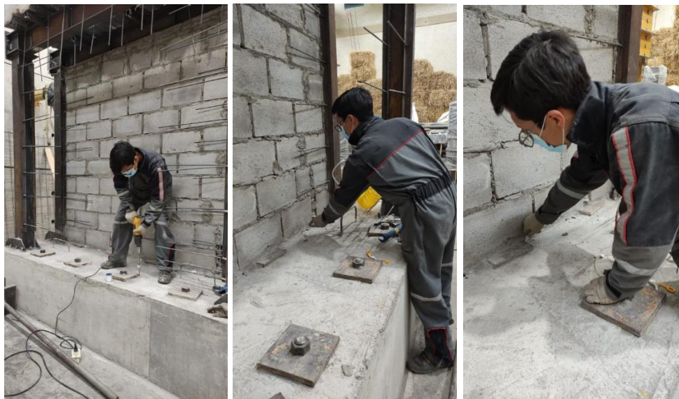
Figura 113. Perforación y limpieza de orificio para colocación de adhesivo de alto desempeño.
