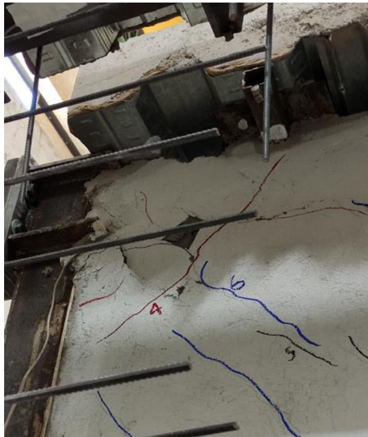
Figura 127. "Daño Moderado" Aplastamiento en las esquinas.
