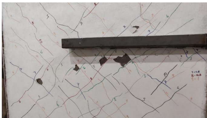
Figura 137. Desprendimiento de mortero no confinado.
