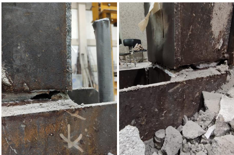
Figura 140. Rotura de acero en base de columna.
