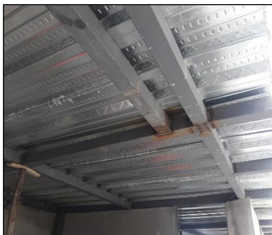
Figura 2. Soldadura y conexión discontinua y deficiente.
