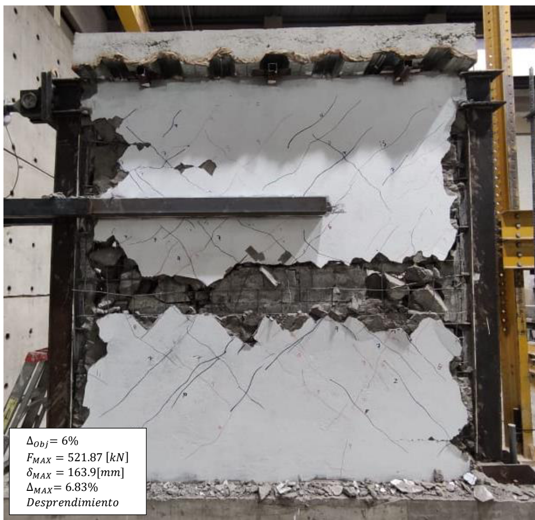
Figura 142. Imagen al final de "Daño Completo"
