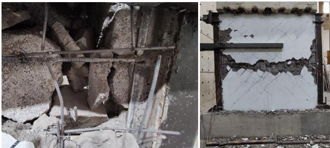
Figura 141. Rotura de malla electrosoldada en diagonal principal - centro de panel.
