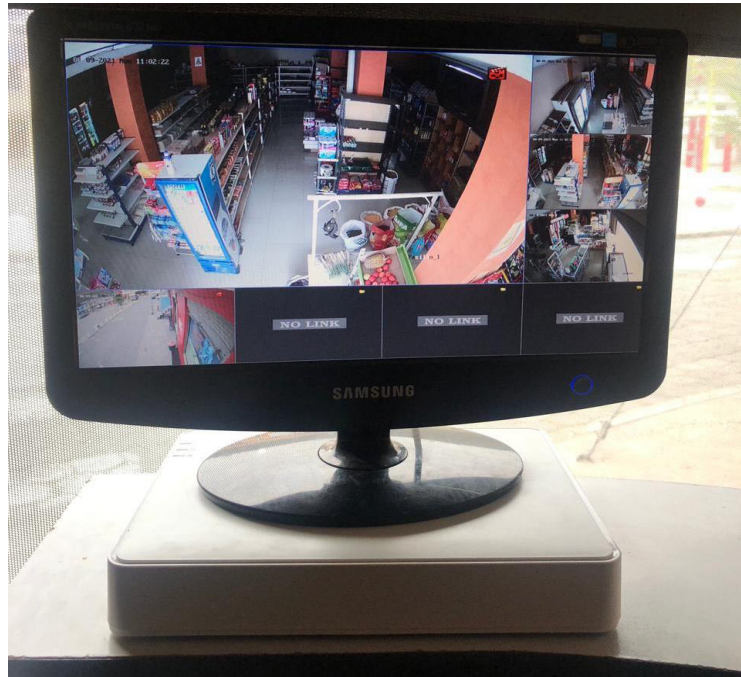
Figura 3.29 NVR y monitor instalado
