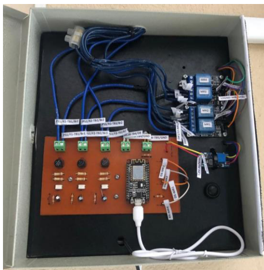
Figura 3.76 Etiquetado de conexiones eléctricas y de datos
