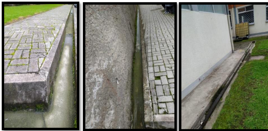
Figura 7. Canales de agua lluvia
