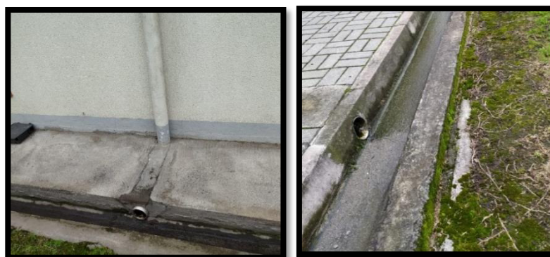
Figura 8. Recolección de agua lluvia en tuberías de PVC
