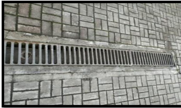
Figura 9. Recolección de aguas lluvia en las aceras
