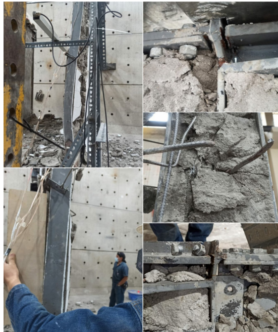
Figura 103. Estado de colapso del prototipo en caso de estudio 4.
