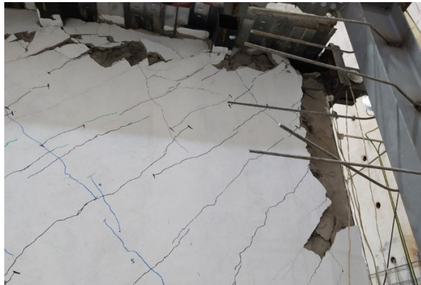
Figura 82. Estado de daño moderado en caso de estudio 1.
