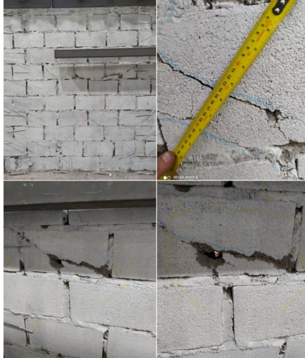
Figura 91. Estado de daño moderado en caso de estudio 3.
