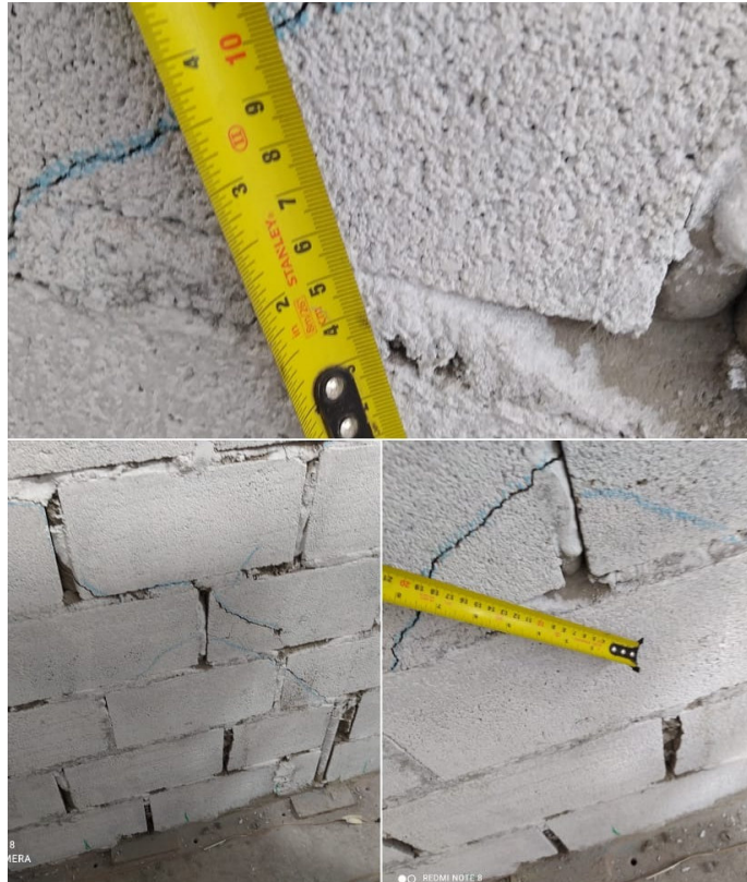
Figura 90. Estado de daño leve en caso de estudio 3. Elaborado: Játiva & Torres (2021).
