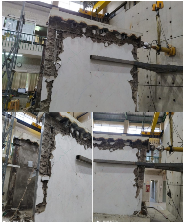
Figura 102. Daño extenso del prototipo en el caso de estudio 4. Elaborado: Játiva & Torres (2021).
