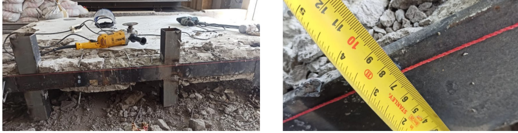
Figura 83. Viga pandeada lateralmente en el caso de estudio 1.
