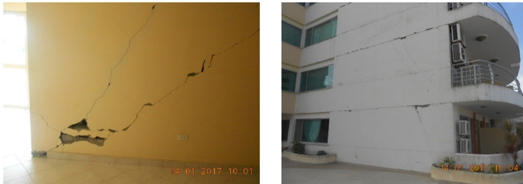
Figura 1. Daños en la mampostería de edificios de acero estructural afectados por el terremoto del 16A en Ecuador.
