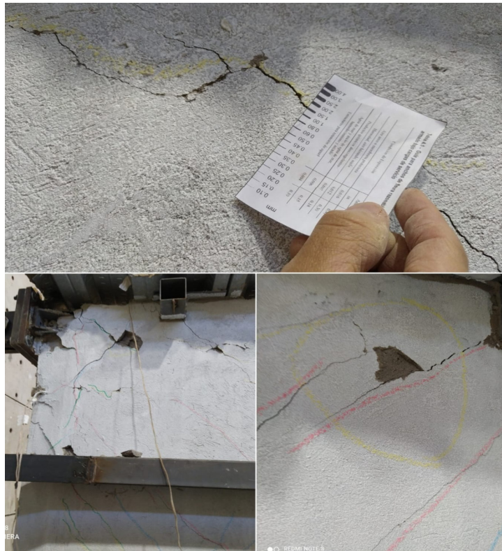
Figura 100. Estado de daño moderado en caso de estudio 4.
