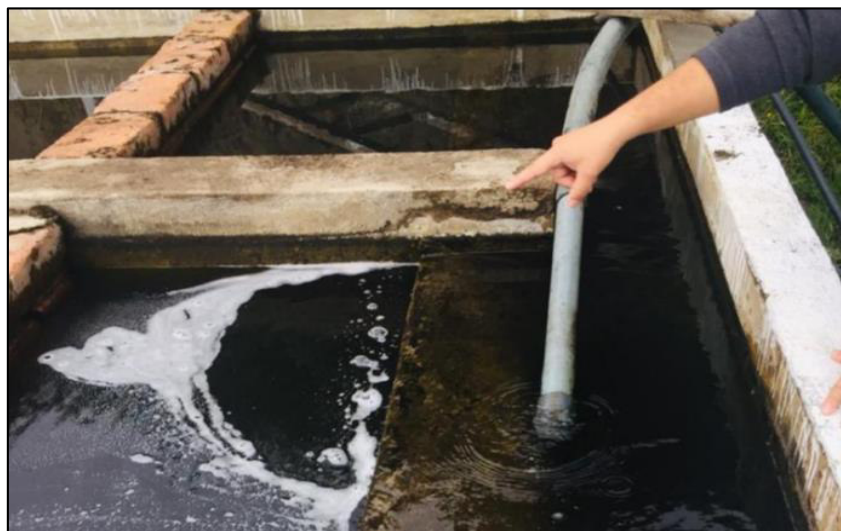
Figura 13 Tubería de la conducción que llega a la planta de tratamiento
