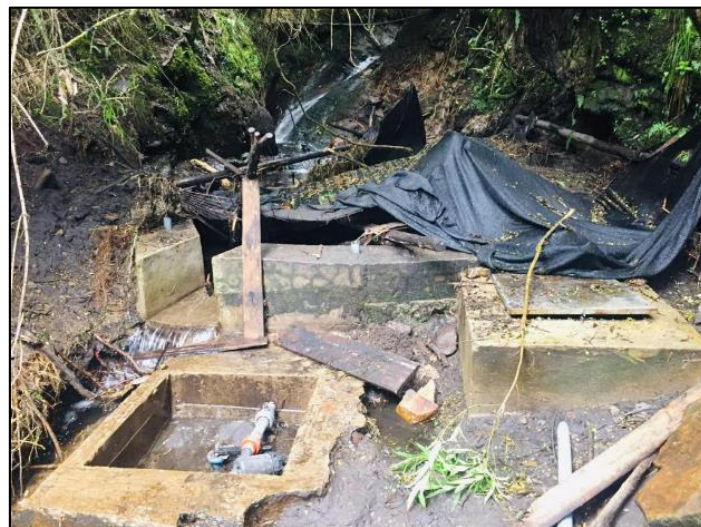
Figura 11 Captación de la comuna M.A.
