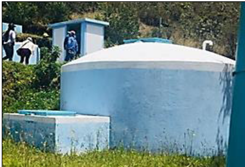
Figura 14 Tanque de almacenamiento
