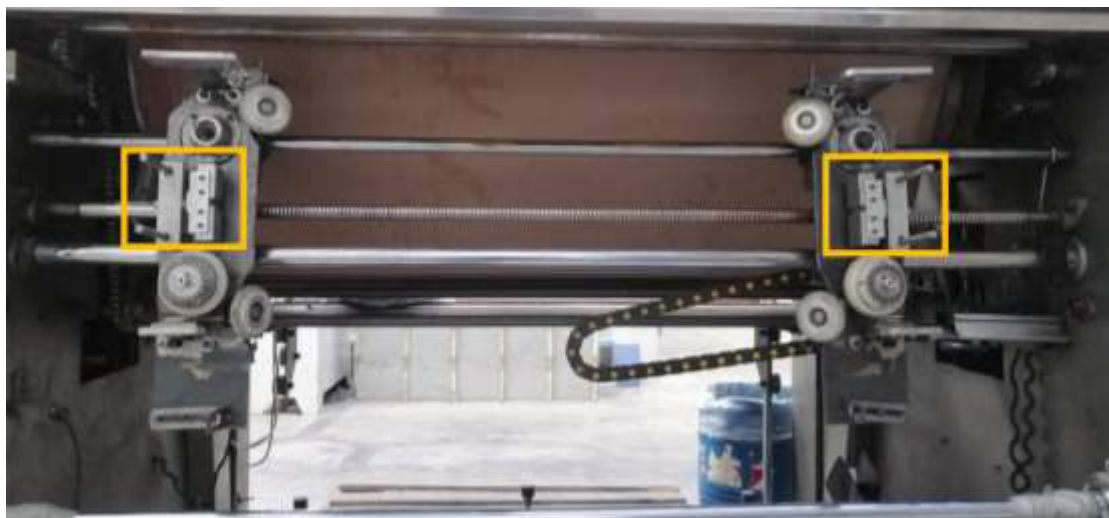
Figura 3.50 Montaje de imanes de alta potencia
