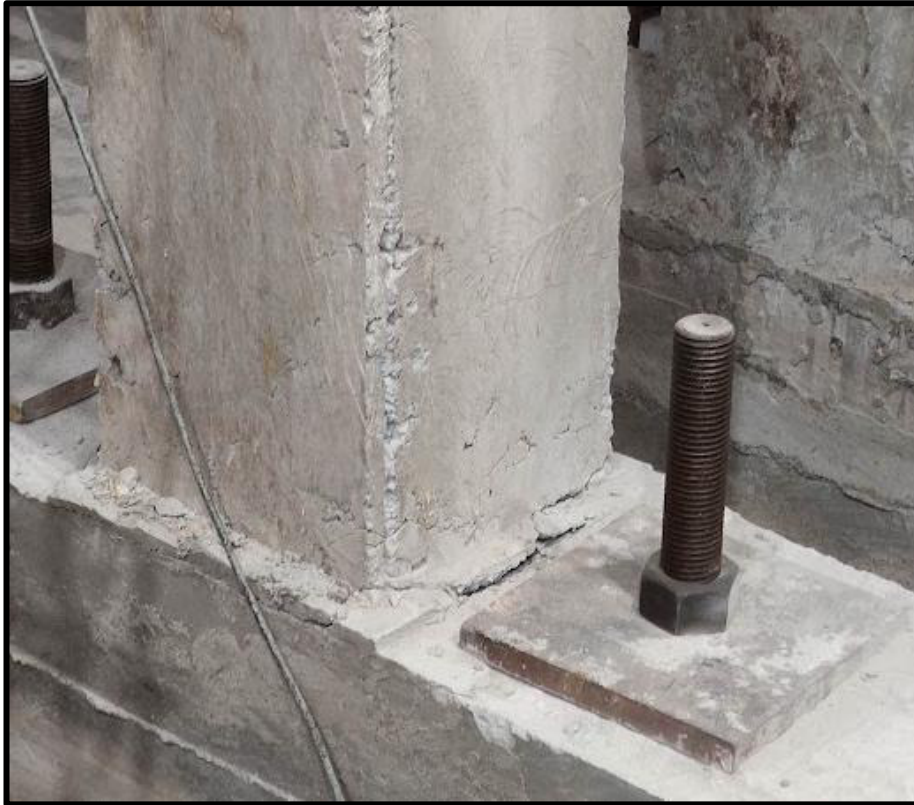
Foto 14. Desprendimiento columna con la viga de cimentación
