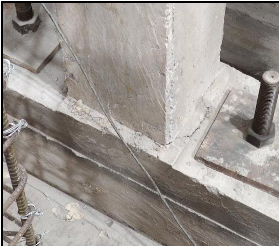
Foto 15. Desprendimiento columna con la viga de cimentación
