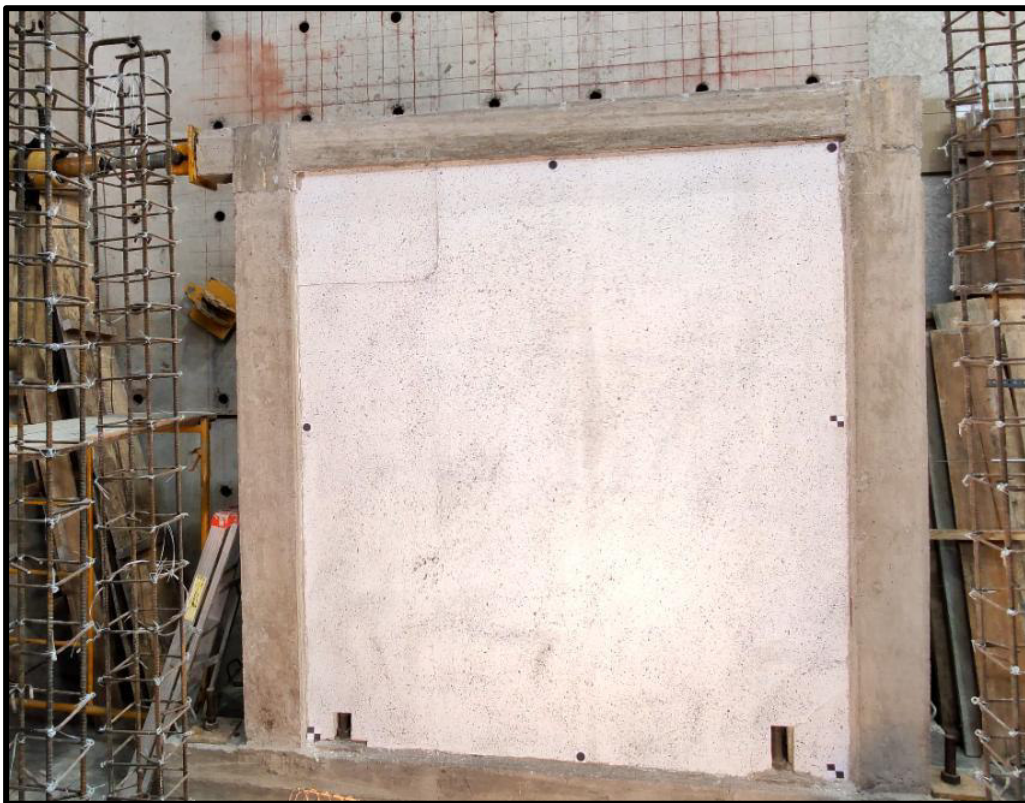
Foto 20. Fisuras Ciclo 35 en el MMS 1 (Empuje →), \Delta=22.76\text{mm} ; P=123.50\text{kN}
