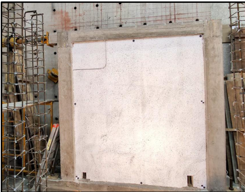
Foto 21. Fisuras Ciclo 35 en el MMS 1 (Halado ←), \Delta=-19.32\text{mm} ; P=-130.37\text{kN}
