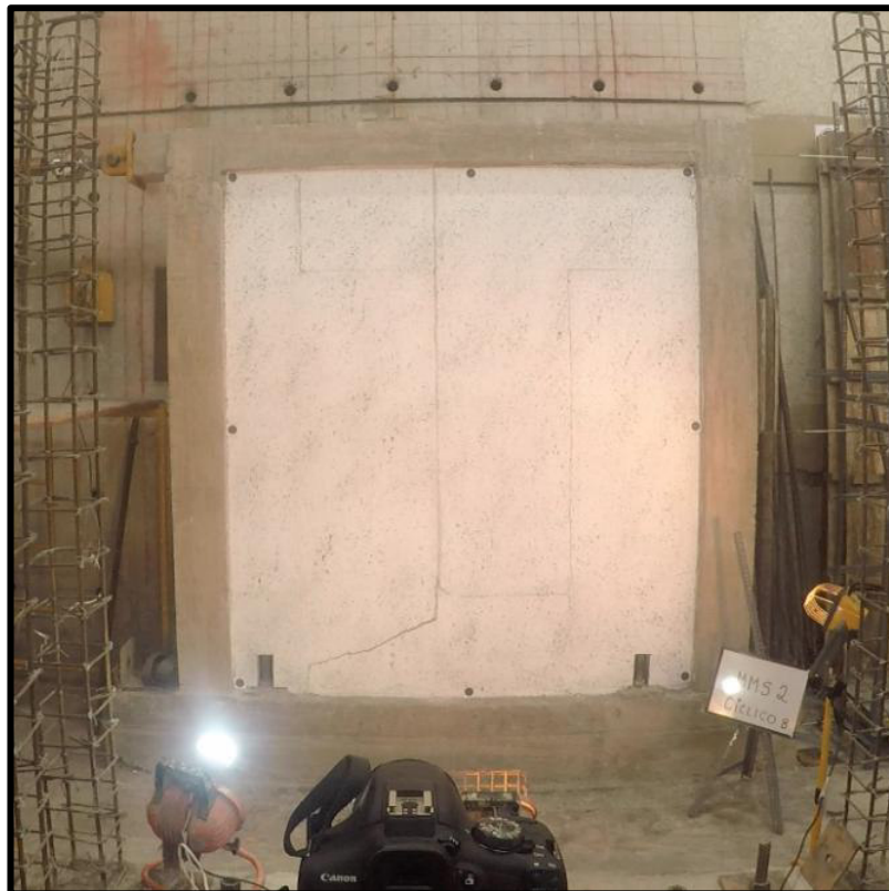
Foto 37. Fisuras Ciclo 8(35) en el MMS 2(Halado ←), \Delta=-19.69\text{mm} ; P=-75.65\text{kN}
