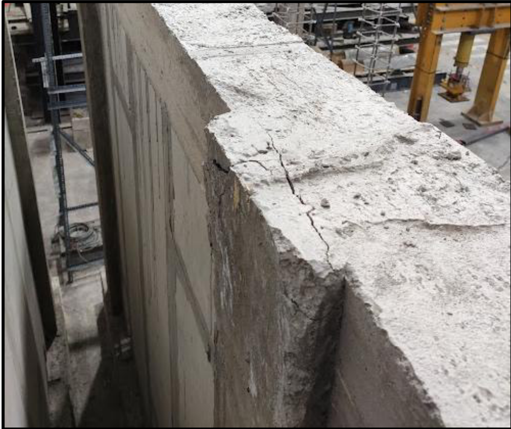
Foto 28. Falla en la conexión viga-columna en el MMS 1
