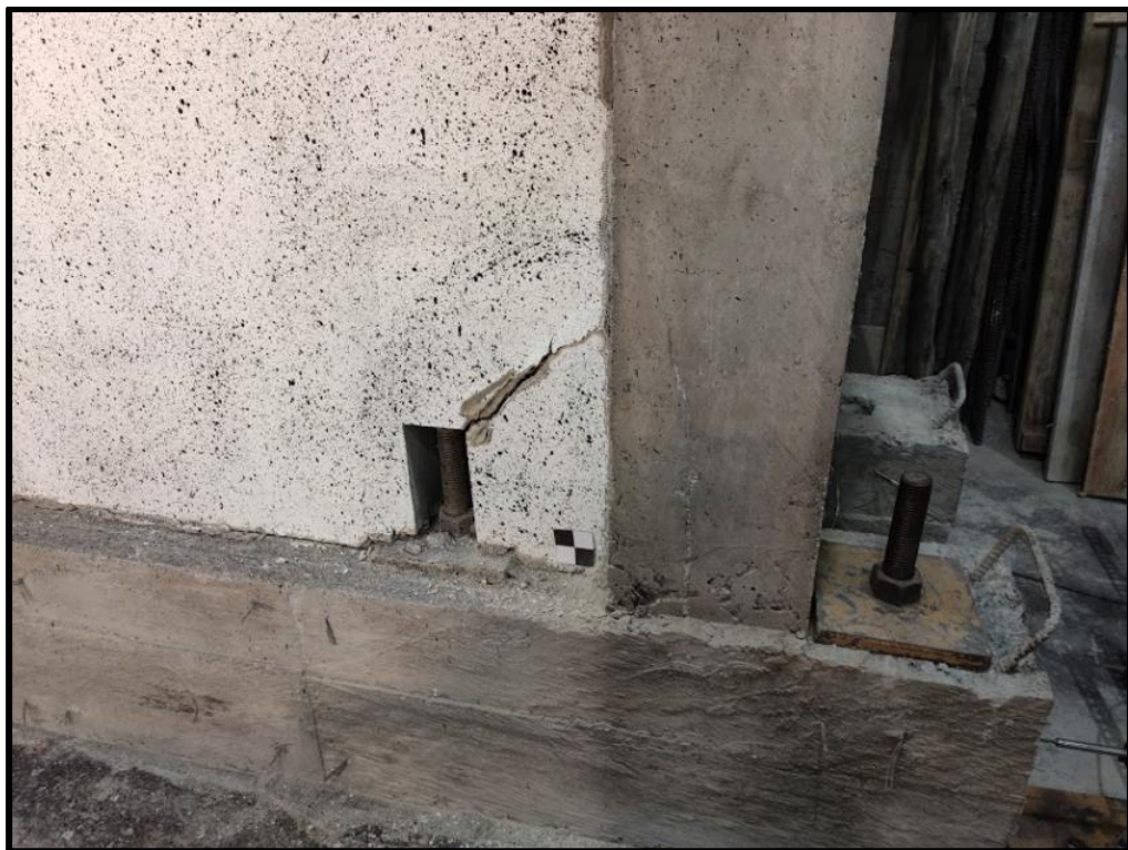
Foto 29. Falla en el panel por abertura de los pernos de anclaje
