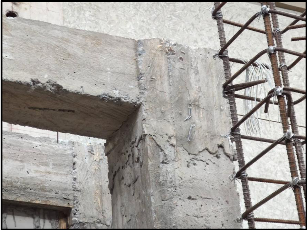
Foto 16. Falla en la conexión viga-columna en el Pórtico
