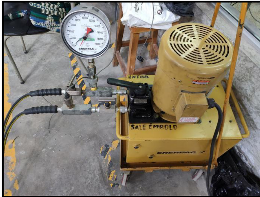
Foto 6. Bomba eléctrica de transmisión de carga (100t)
