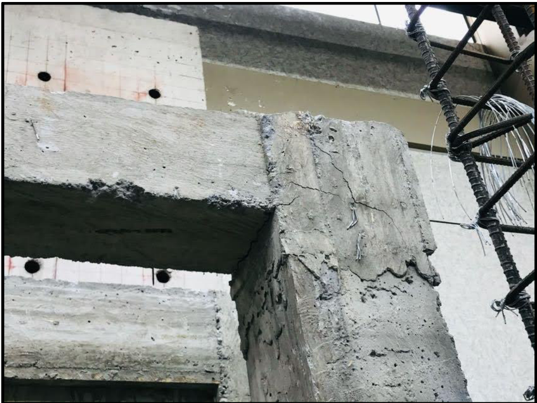
Foto 17. Falla en la conexión viga-columna en el Pórtico
