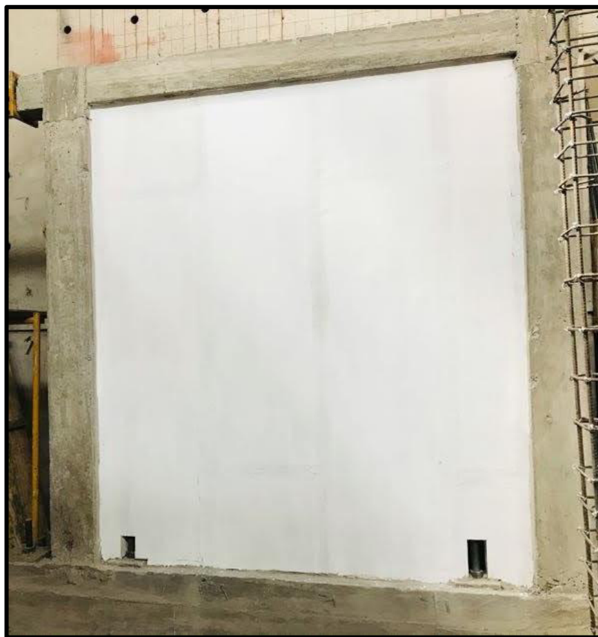
Figura 4.11. MMS 2 antes del ensayo
