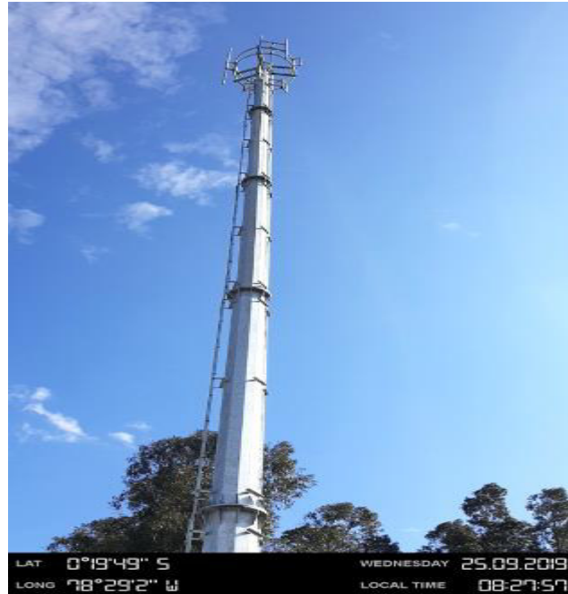
Figura 2. 3. Torre Tipo Monopolo
