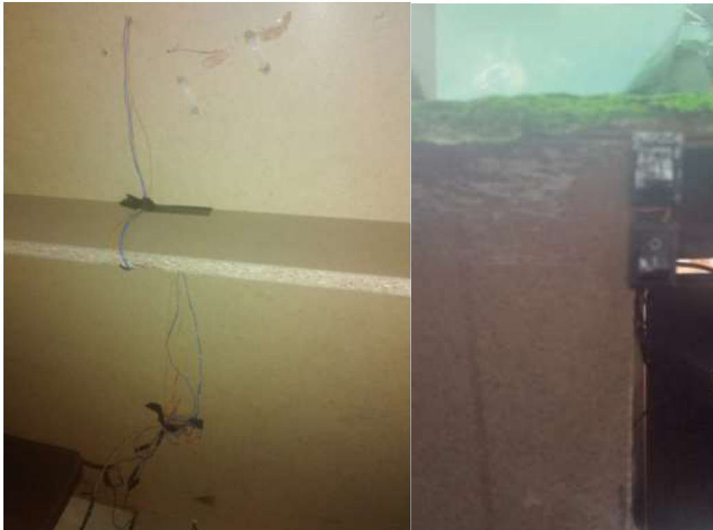
Figura 3.25 Circuito de alimentación de motores de vibración
