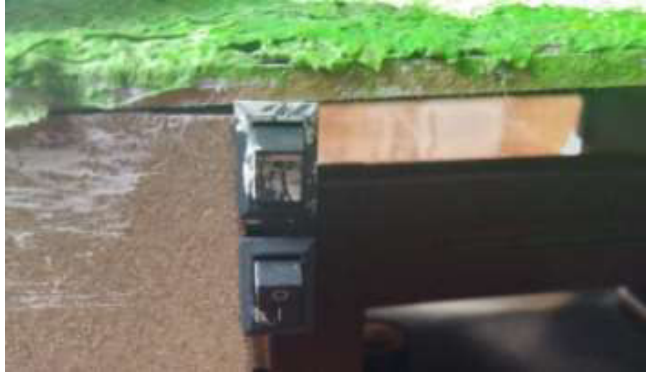
Figura 3.40 Switches de encendido de motores
