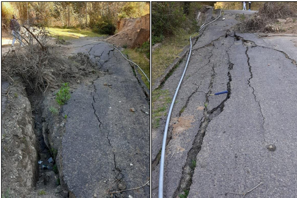
Fotografía 40 Grietas formadas en la carretera vía antigua Pujilí - Cachi Alto. UTM 750942 – 9892535 (Foto: K. Arequipa-EPN).
