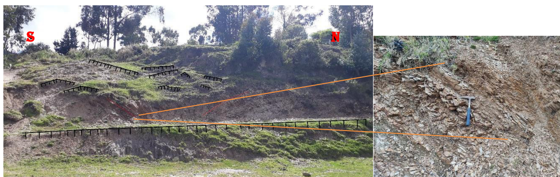
Fotografía 33 Lutitas que presentan deformación y fracturación en la parte superior se observan escarpes con dirección NE-SW UTM 750197 – 9892125 (Foto: K. Arequipa-EPN).
