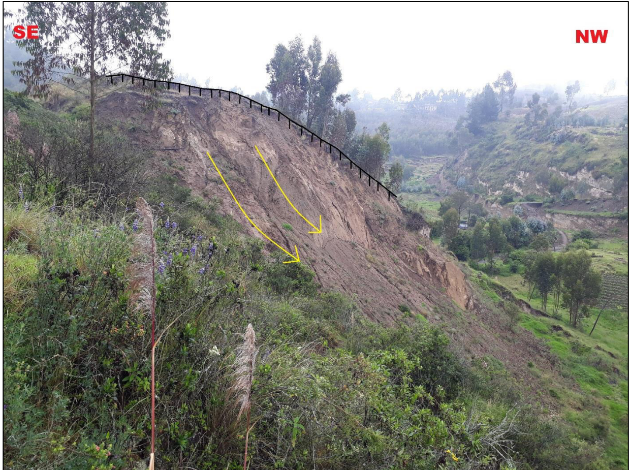
Fotografía 3 Deslizamiento de tamaño pequeño se observa el escarpe de color negro y la dirección del movimiento de color amarillo UTM 750993 – 9892639 (Foto: K. Arequipa - EPN).
