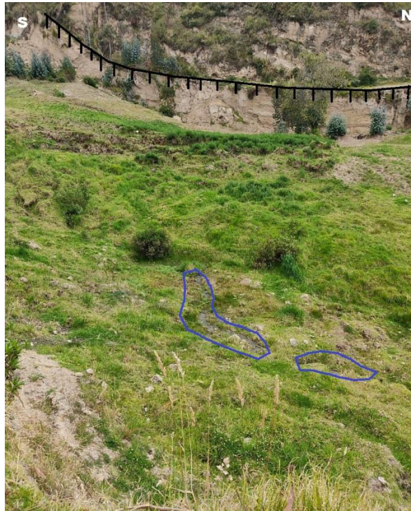
Fotografía 41 Presencia de vertientes de agua a lo largo del cuerpo del deslizamiento activo de mediano tamaño marcados de color azul (Foto: K. Arequipa-EPN).
