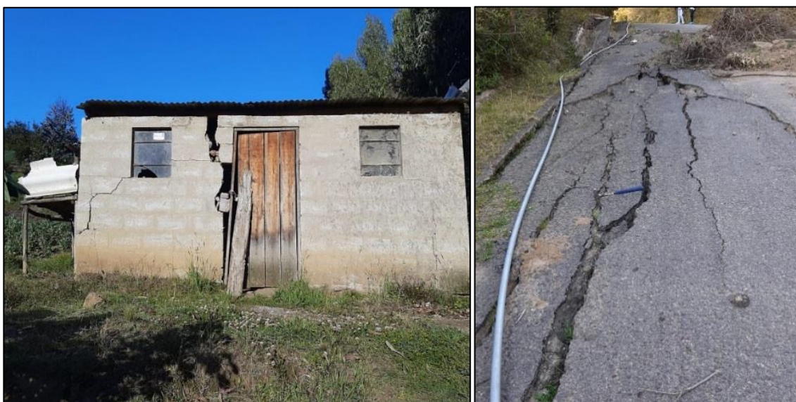
Fotografía 1 Fotografía En la izquierda se observa la afectación de una construcción tipo casa, la cual presenta fracturas y desplazamiento en su estructura. En la derecha de tracción son muy evidentes en las vías que rodean la zona del deslizamiento (UTM: 750911 - 9892520) (K. Arequipa – EPN)
