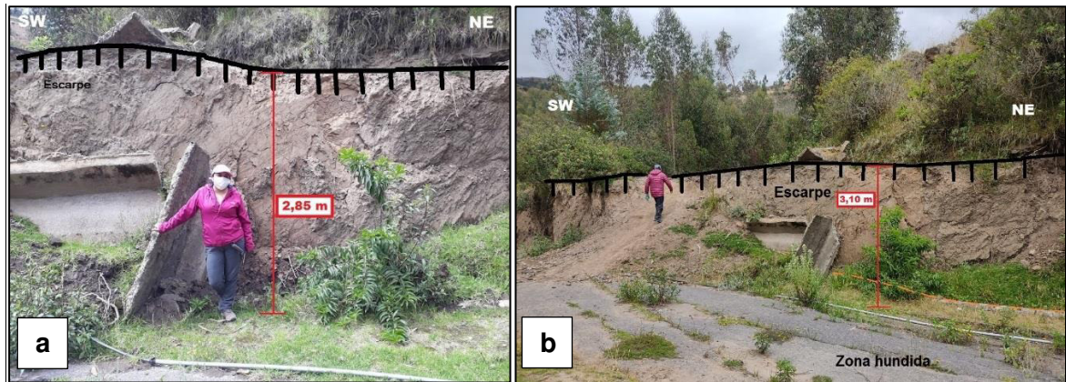
Fotografía 36 Estructura morfológica en la vía antigua de Pujilí - Cachi Alto. El trazo de color negro representa un escarpe, las líneas discontinuas de color tomate representa el escarpe del deslizamiento reactivado a) Foto tomada el 01 de febrero de 2021 b) Foto tomada el 12 de julio de 2021 (Foto: K. Arequipa-EPN)
