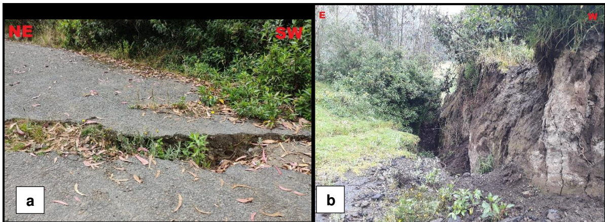
Fotografía 26 a) agrietamiento en la carretera antigua Pujilí - Cachi Alto UTM 750944 - 9892559 b) Agrietamiento que se forma por el desplazamiento del deslizamiento reactivo con dirección NE-SW. UTM 750929 – 9892542 (Foto: K. Arequipa - EPN).
