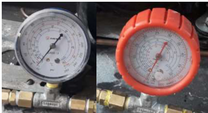
Figura 3.8 Manómetros de baja y alta presión.
