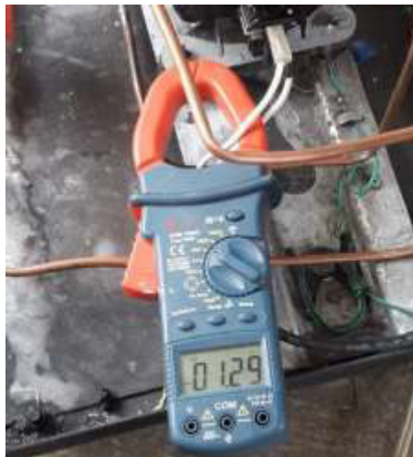
Figura 3.30 Corriente de trabajo del compresor para la carga del R-134a.
