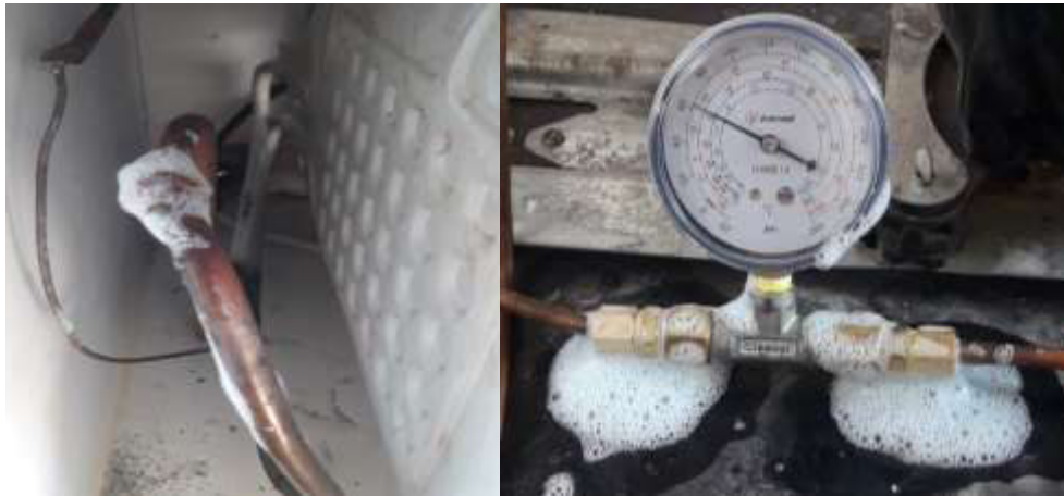
Figura 3.25 Inspección visual para localizar fugas.
