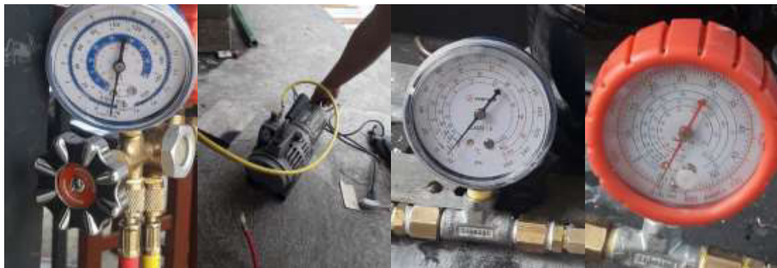
Figura 3.28 Proceso de vacío en el sistema de refrigeración.
