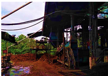
Fotografía 3: Calderas de la extractora "LA JOYA". Elaborado por: Chiquito, J & Eras, G
