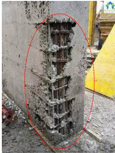
Figura 8: Presencia de coqueras o ratoneras. Fuente: (Torrent, 2020)
