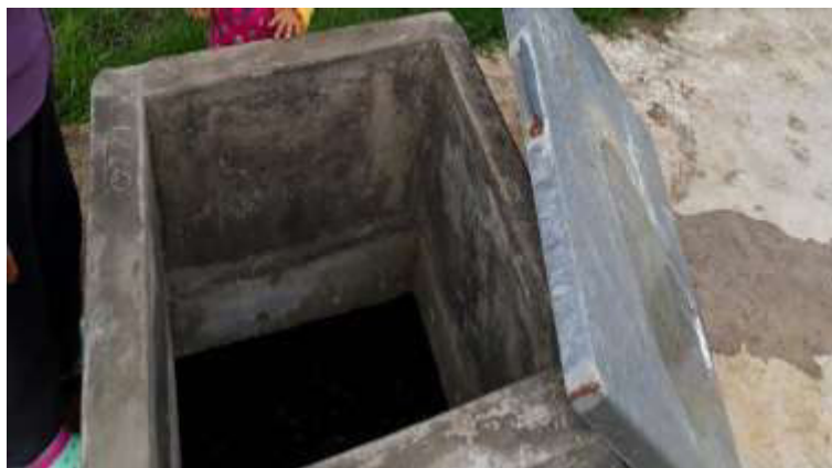
Figura 52. Tanque de almacenamiento
