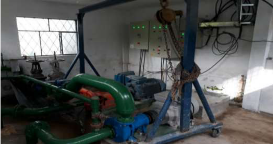
Figura 8. Cuarto de sistema de bombeo
