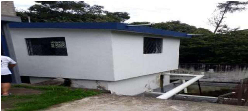
Figura 6. Tanque de cuarto de filtros
