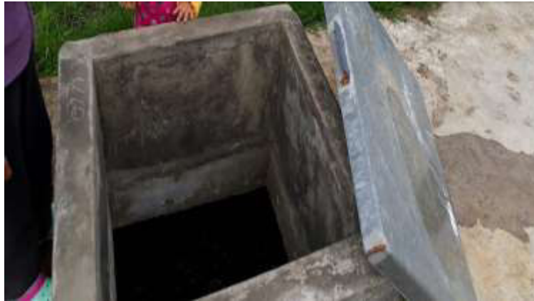
Figura 2. Tanque de almacenamiento
