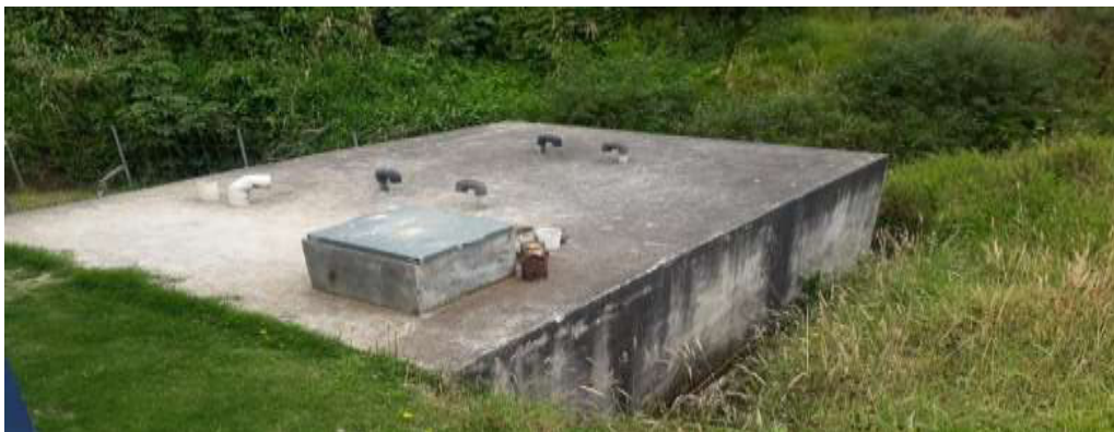
Figura 7. Tanque de almacenamiento
