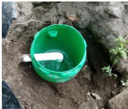
Figura 55. Tanque de almacenamiento del efluente
