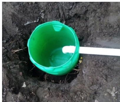
Figura 39. Tanque de almacenamiento del efluente
