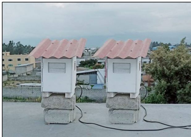
Figura 3.35. Instalación de AWS de calibración.
