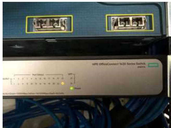
Figura 3.37 Cambio de switch HP 1420-24g-2sfp
