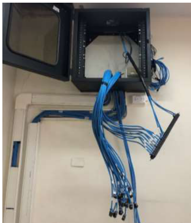
Figura 3.21 Desarmado del rack de comunicaciones
