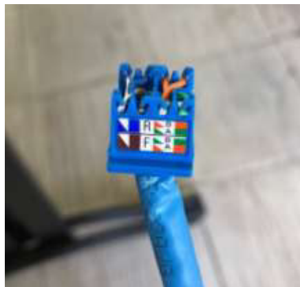
Figura 3.18 Ponchado de jacks T- 568B
