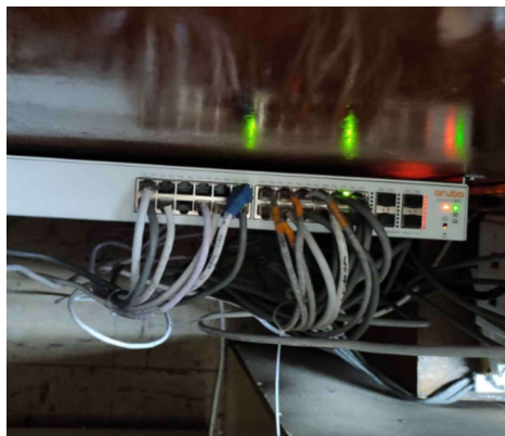
Figura 2.3 Switch de red - sala de profesores escuela
