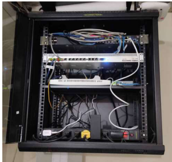
Figura 2.5 Rack – área administrativa
