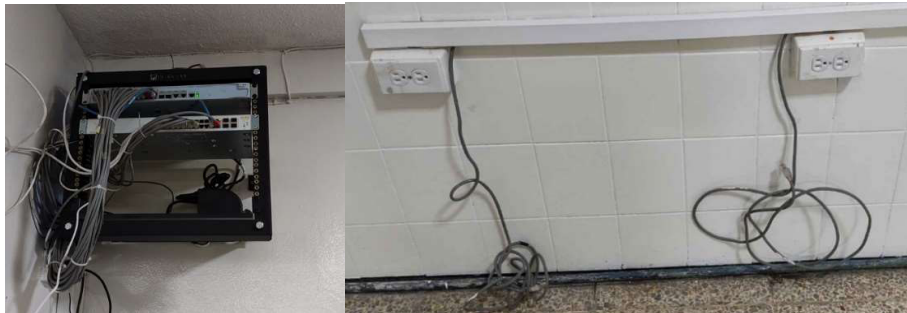
Figura 2.10 Mini Racks en laboratorios de computación e instalaciones de red.
