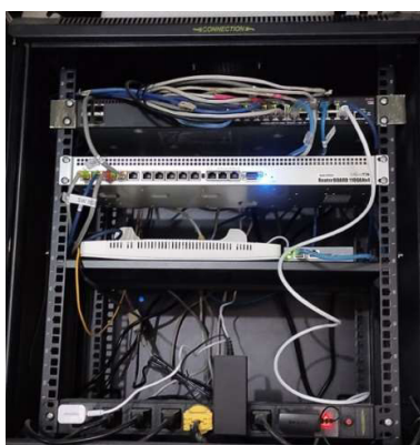
Figura 2.12 Equipos mini rack área administrativa
