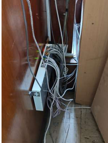
Figura 2.9 Switch en áreas de trabajo del personal
