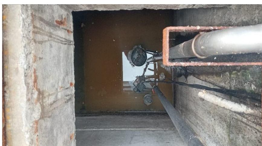
Figura 5 Tanque de captación y bombas sumergibles
