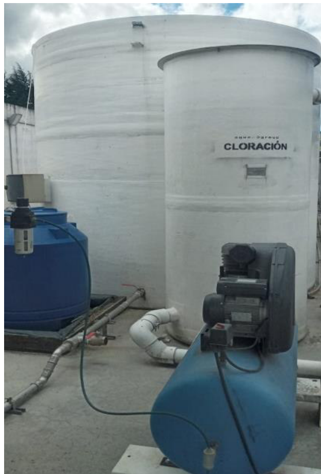
Figura 11. Tanque de cloración
