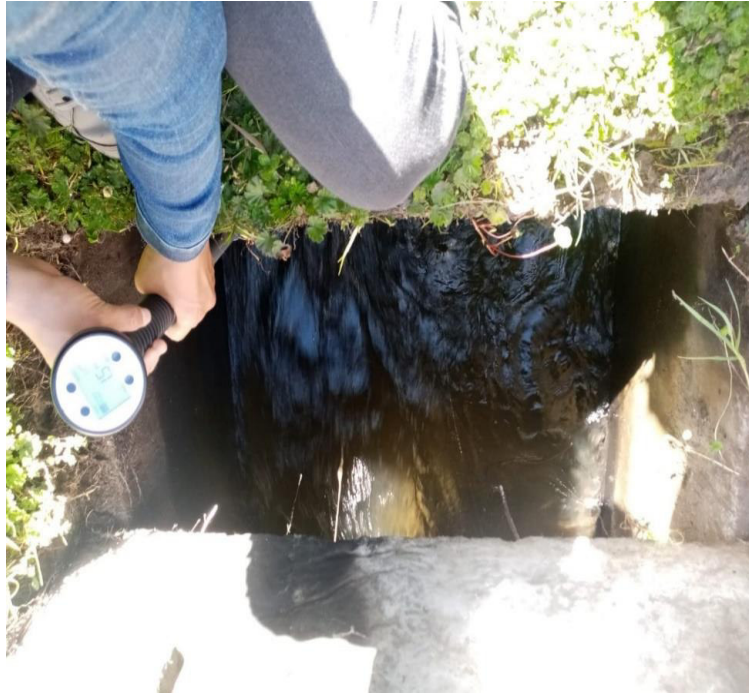
Figura 5: Canal de abastecimiento
