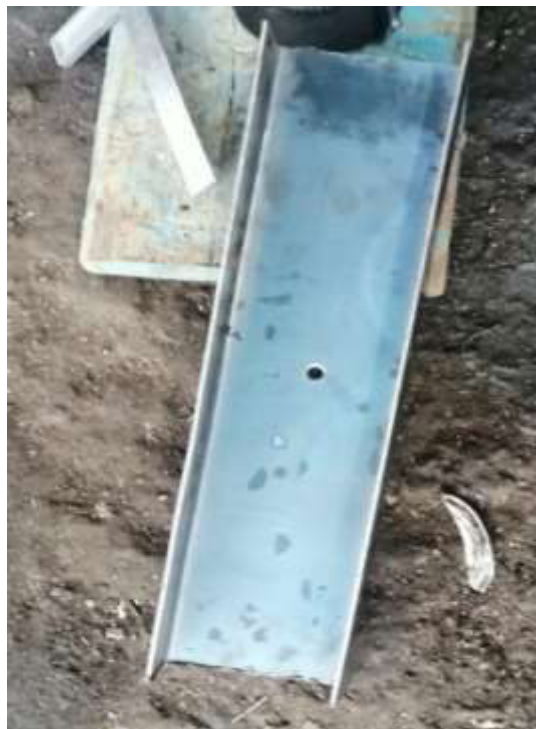
Figura 3.15 Estructuras metálicas de soporte para matrices
