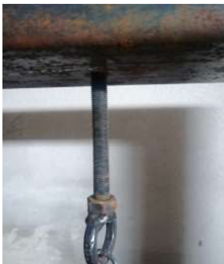
Figura 3.24 Anclaje de los pernos con los cáncamos
