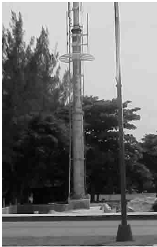
Figura 1.7 Torre tipo monopolo.
