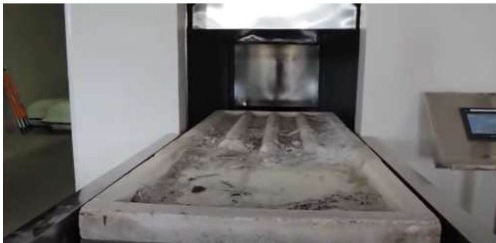
Figura 1.5. Compuerta de entrada incinerador. Fuente: [6]
