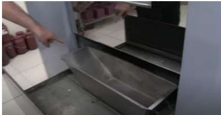
Figura 1.2. Tolva de recolección de restos incinerados. Fuente: [3]
