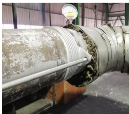
Figura 17. Sección de tubería sin la presencia de aislante térmico (Fuente: Propia).
