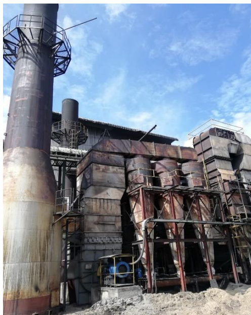
Figura 4. Exterior de la caldera (Fuente: Propia).
