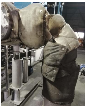
Figura 18. Aislante térmico removible en tubería cercana al turbo (Fuente: Propia).
