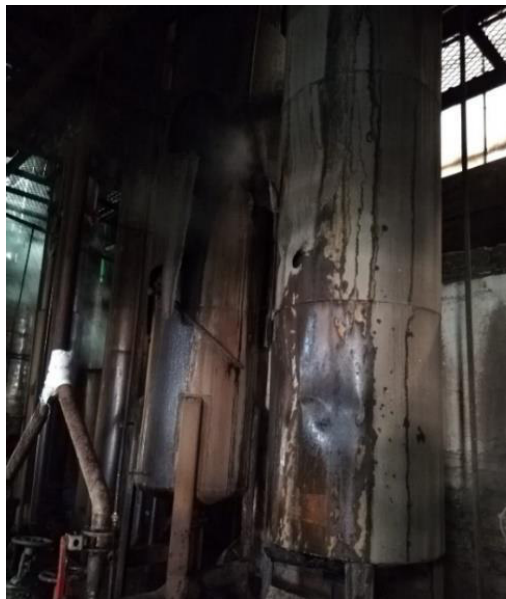
Figura 8. Condensados (Fuente: Propia).
