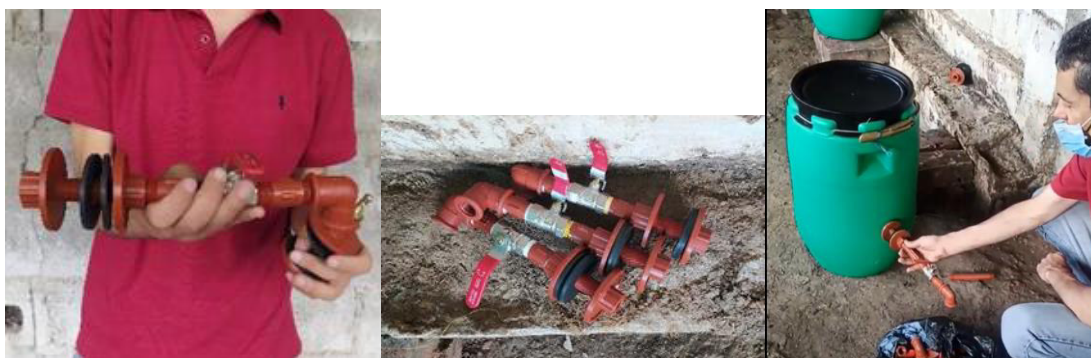
Fotografía 2.2.1.3. Conexión para salida de BIOL.
