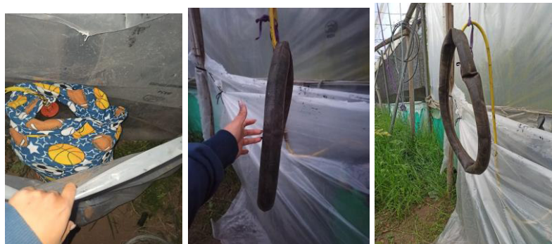
Fotografía 2.2.6.3. Cobijamiento del biodigestor EXT y evidencia de generación de gas
