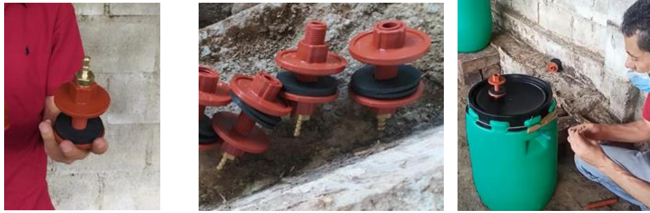
Fotografía 2.2.1.4. Conexión para salida de BIOGAS.
