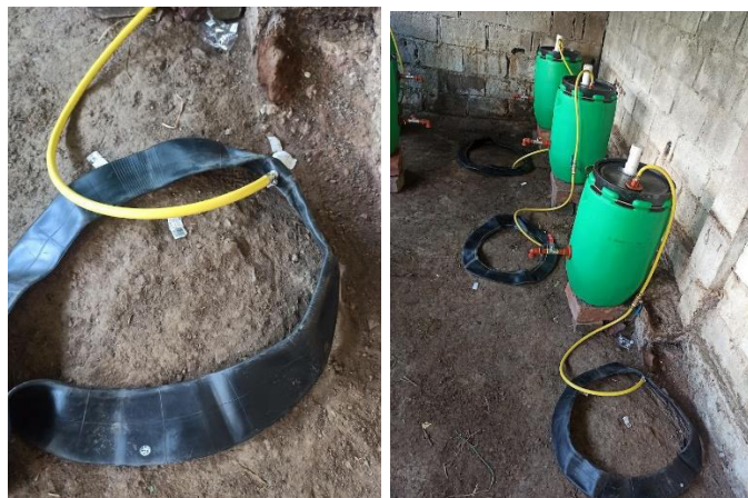
Fotografía 2.2.1.7. Instalación de mangueras boyas almacenadoras de gas.
