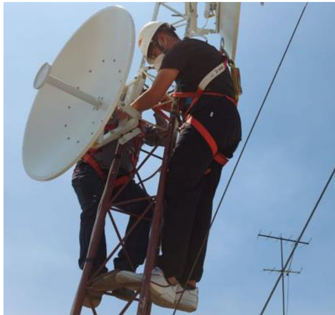
Figura 3.23 Implementación de la antena en la torre de la empresa
