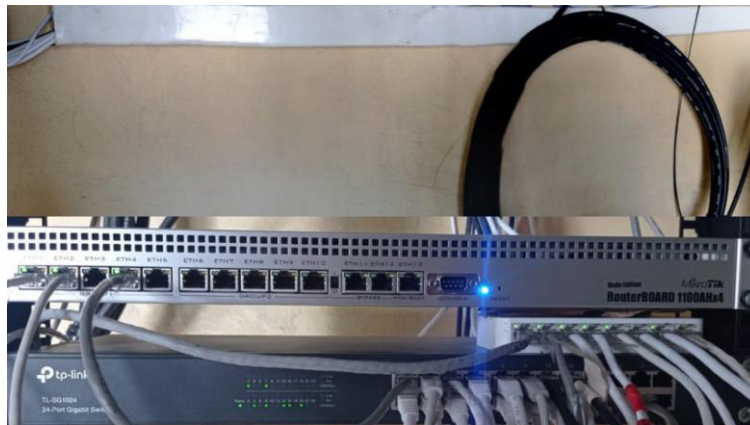
Figura 3.33 Conexión en la central
