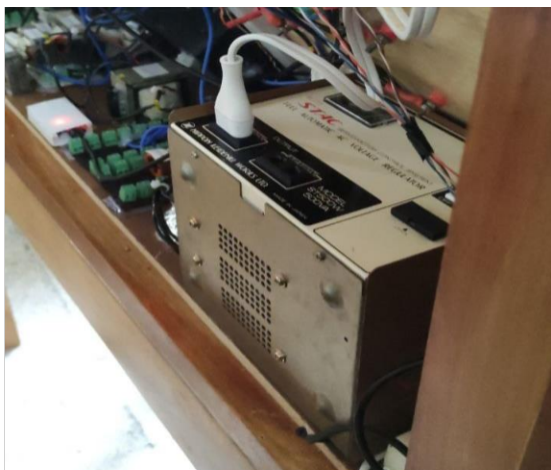
Figura 2.2. Estabilizado de voltaje a 120 V, AC.
