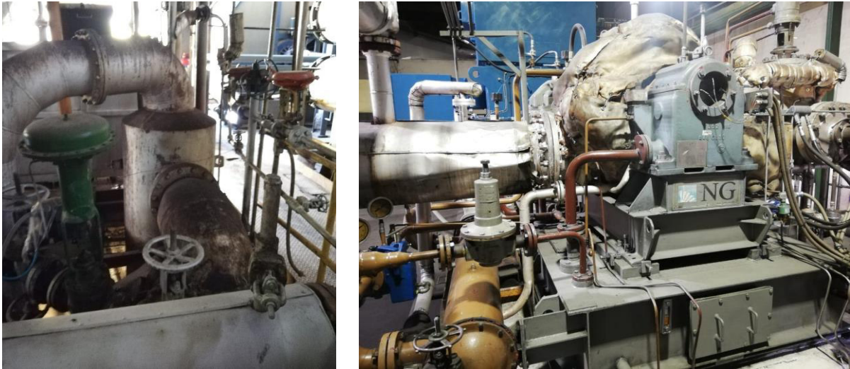
Figura 20. (a) Sistema de vapor (b) Turbogenerador (Fuente: Propia).
