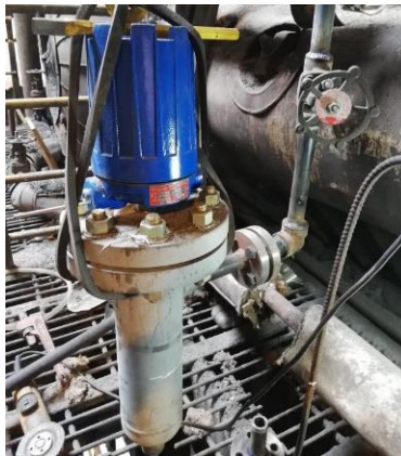
Figura 14. Sensor de nivel (Fuente: Propia).
