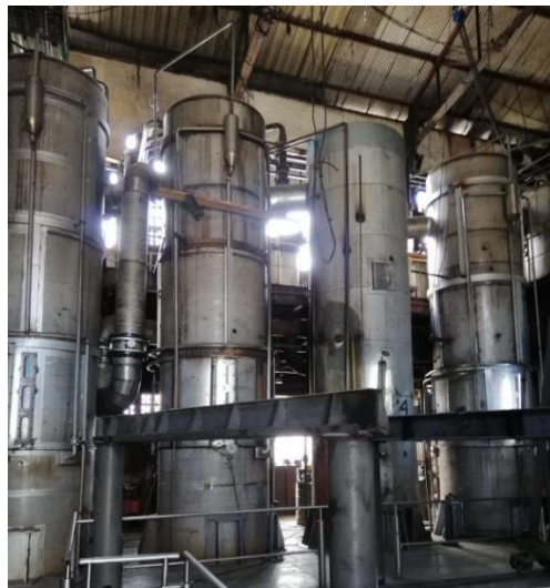
Figura 8. Evaporadores (Fuente: Propia)
