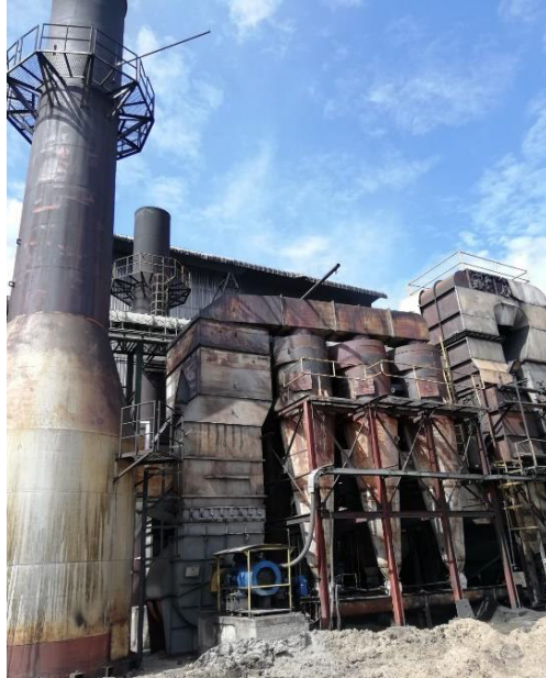
Figura 13. Exterior de la caldera (Fuente: Propia).
