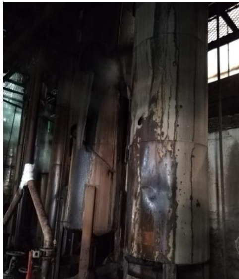
Figura 17. Condensados (Fuente: Propia).
