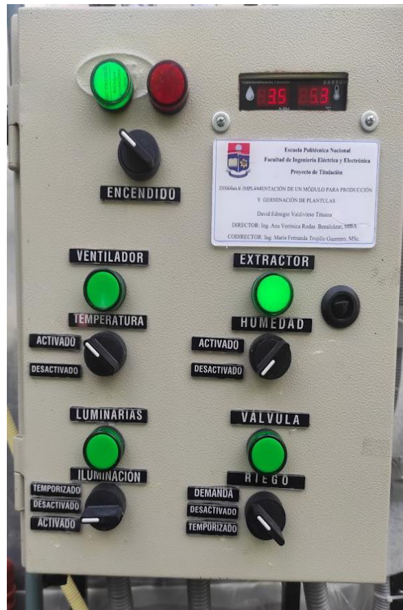
Figura 2.67. Parte Frontal del tablero de Control
