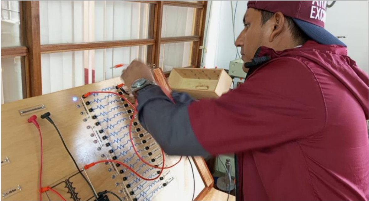
Figura III.11. Conexionado para obtener las lecturas de caída de voltaje en el circuito secundario
